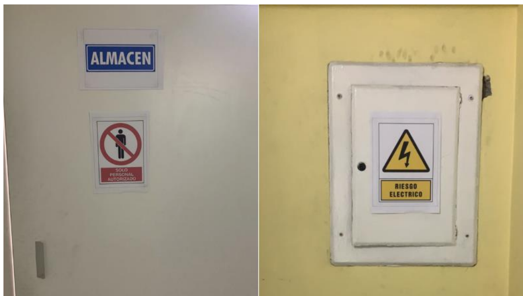
Figura 170. Señalización en las instalaciones
