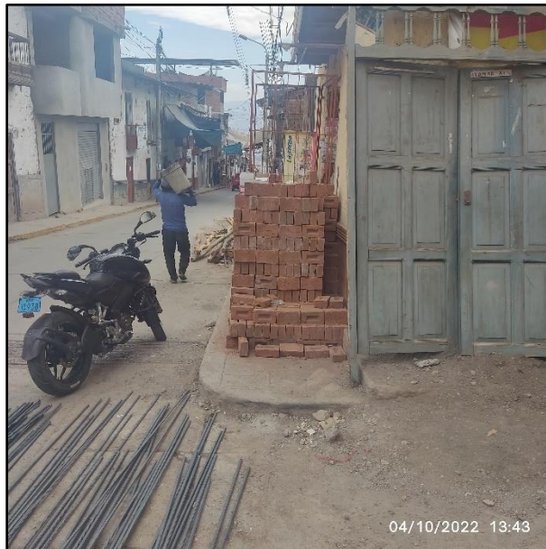
Figura 16: Obstrucción de vereda en el Jr. Lima por materiales de construcción.
