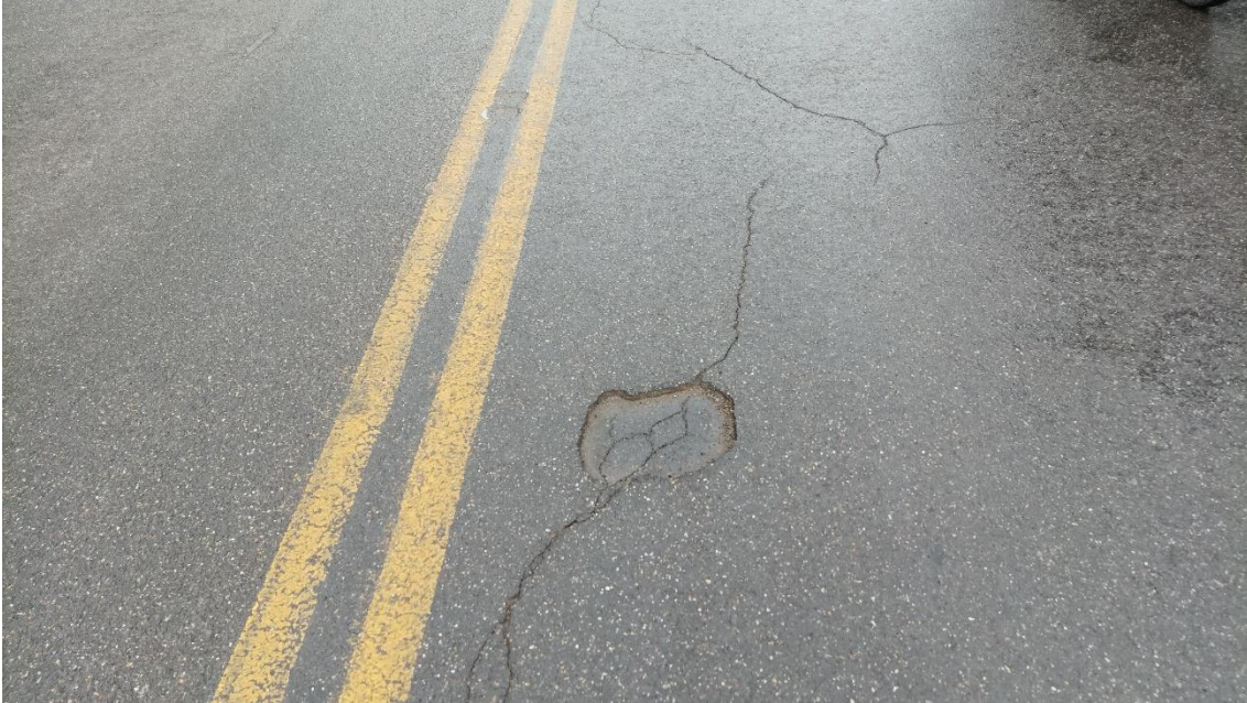
Foto 03: Km 1+250: Patología Fisuras longitudinales
