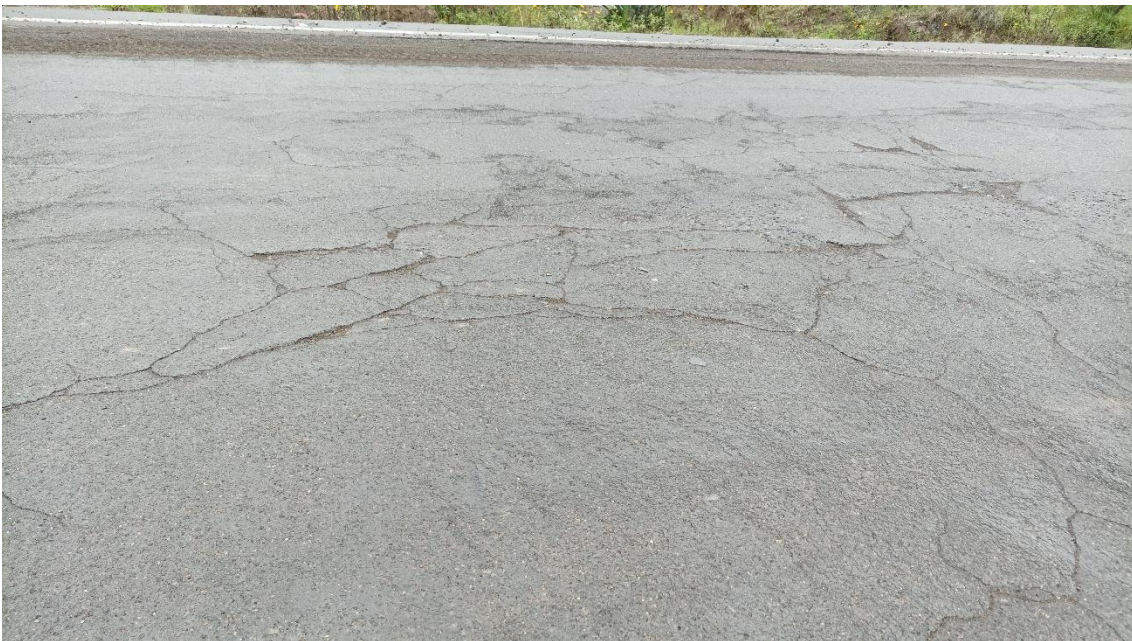
Foto 08: Km 2+100: Patología Piel de cocodrilo y pulimento de agregados
