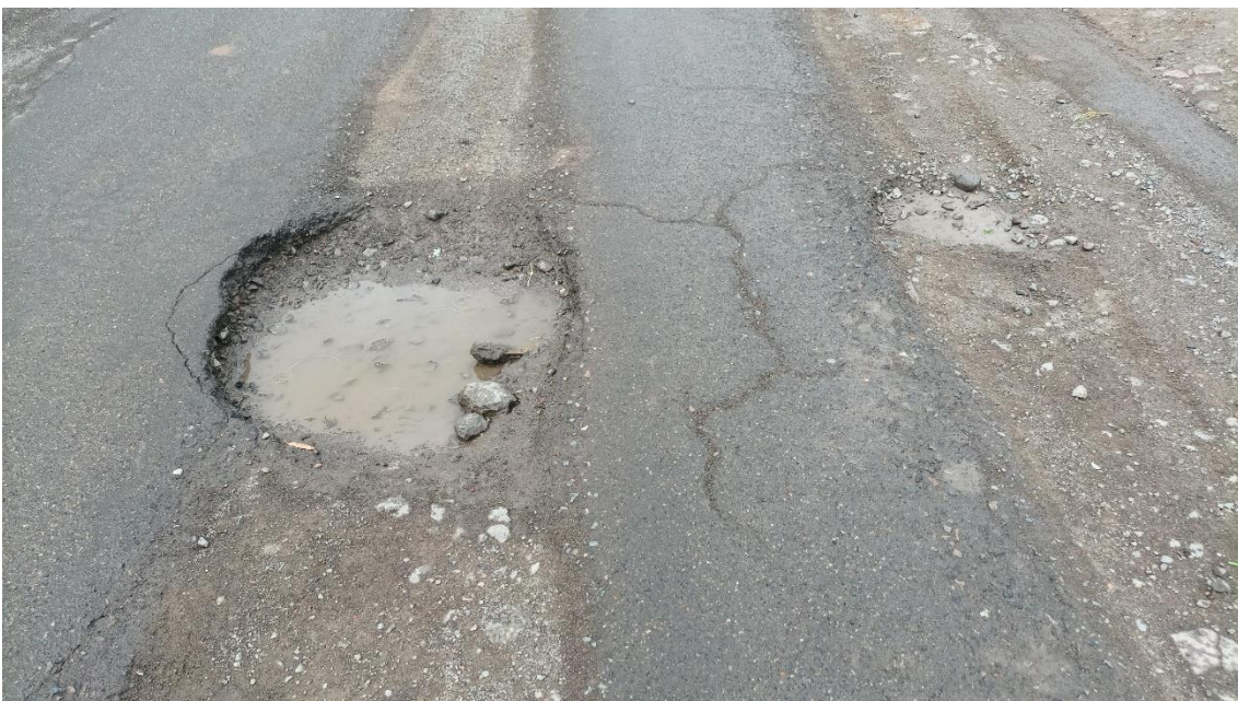
Foto 15: Km 2+900: Pavimento Fallado
