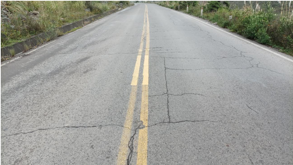
Foto 02: Km 1+100: Patología agrietamiento en bloque
