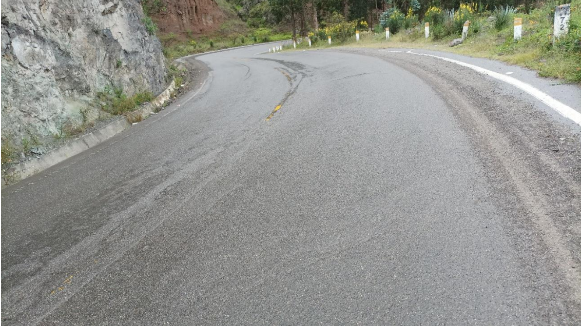
Foto 07: Km 2+000: Patología Pulimento de agregados
