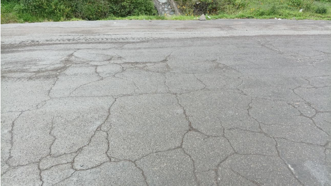
Foto 16: Km 2+910: Pavimento Fallado
