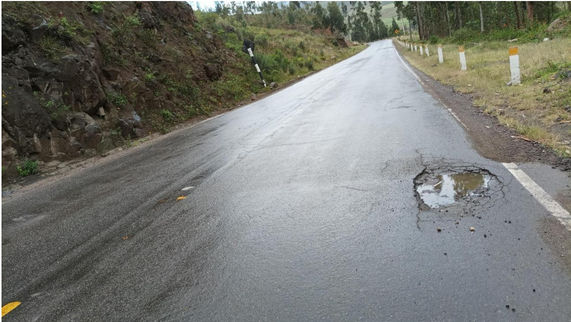
Foto 09: Km 2+160: Patología hueco y pulimento de agregados
