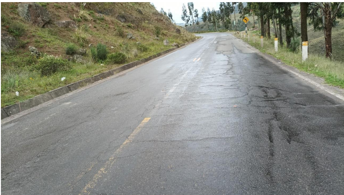
Foto 11: Km 2+600: Patología Piel de cocodrilo y falla en bloque
