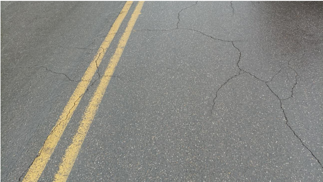
Foto 04: Km 1+640: Patología Fisuras longitudinales y transversales
