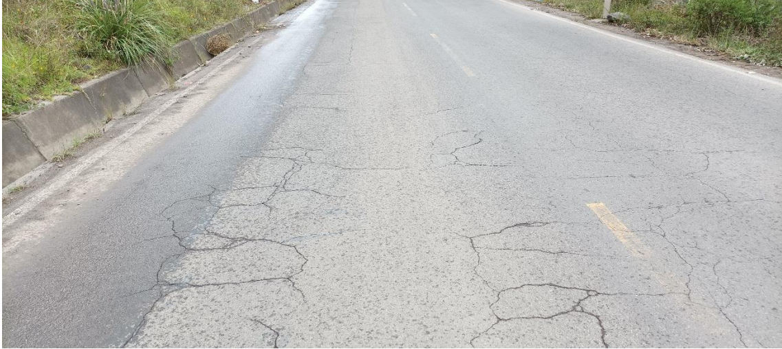
Foto 01: Km 1+000: Patología Piel de cocodrilo
