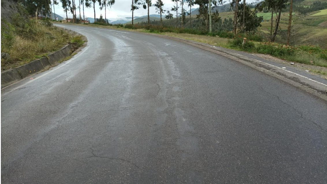
Foto 12: Km 2+700: Patología Piel de cocodrilo y pulimento de agregados
