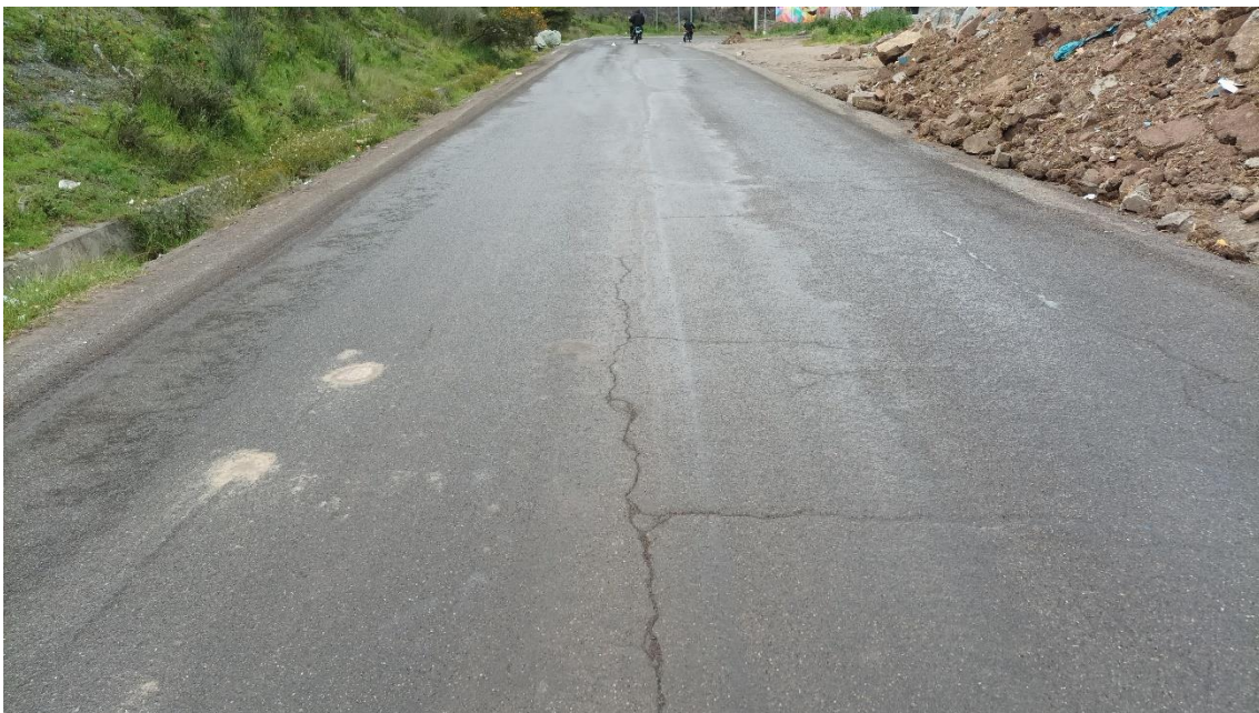
Foto 13: Km 2+285: Patología Piel de cocodrilo y falla en bloque
