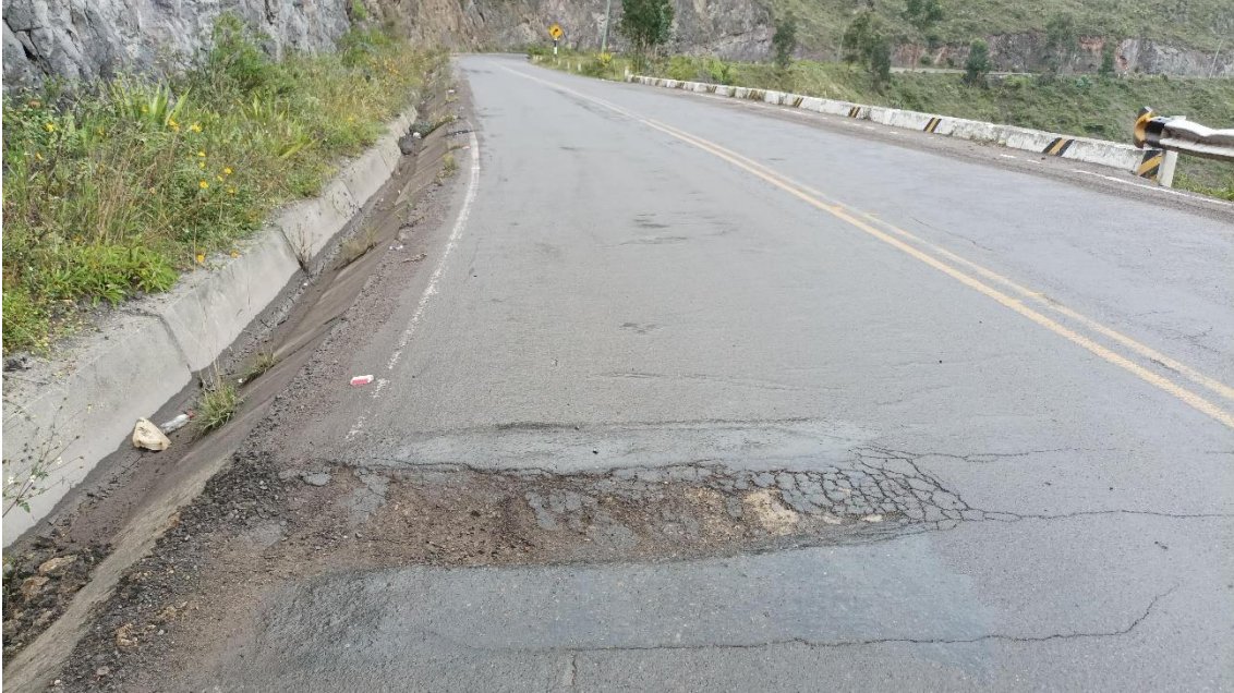
Foto 05: Km 1+700: Patología deformación superficial
