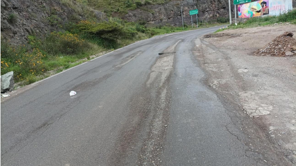
Foto 14: Km 2+900: Pavimento Fallado
