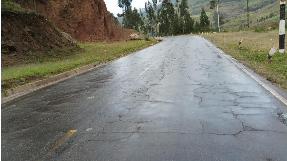
Foto 10: Km 2+280: Patología Piel de cocodrilo y falla en bloque
