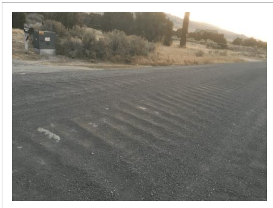
Corrugación en los pavimentos flexibles
