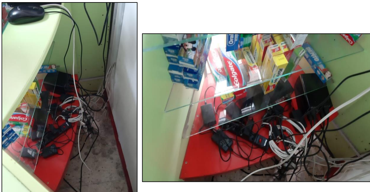
Figura 54. Riesgo de incendio y/o cortocircuitos
