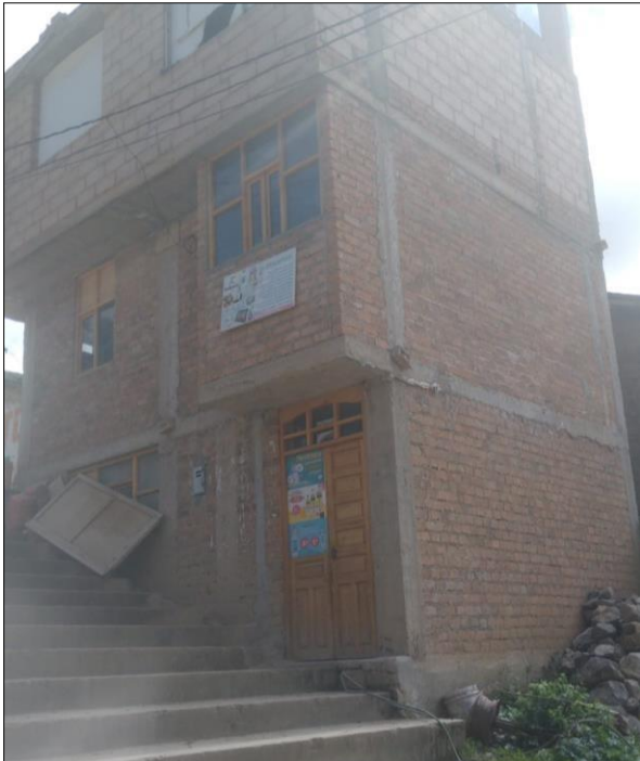
Irregularidad vertical moderada - Sitio en pendiente
