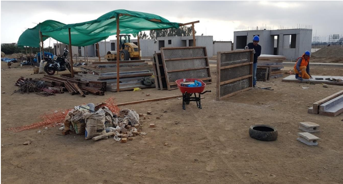
Figura 42. Habilitando los materiales para dejarlo en almacén, verificando el avance de obra.
