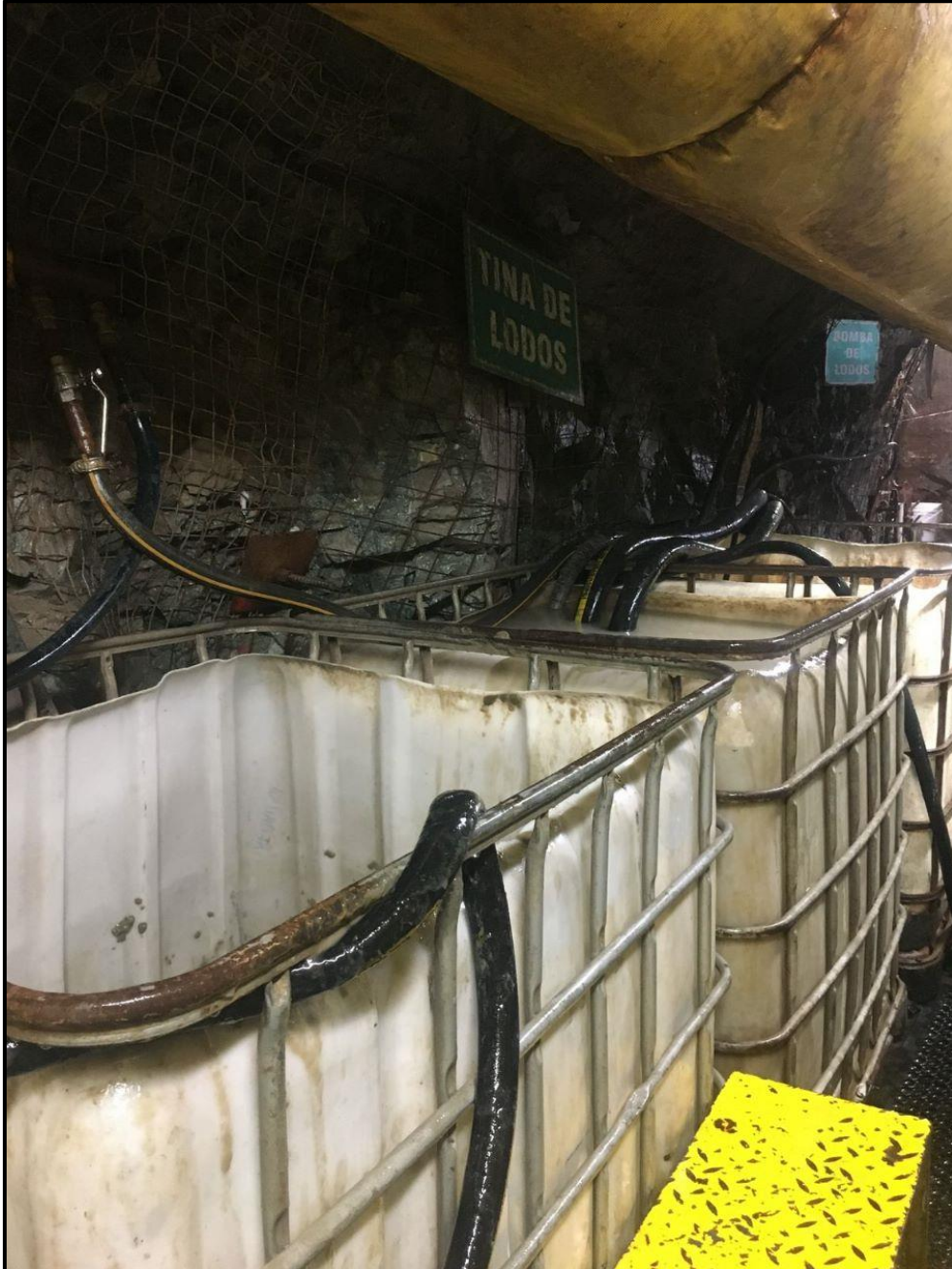
Figura 12: Tina de Lodos y tuberías.
