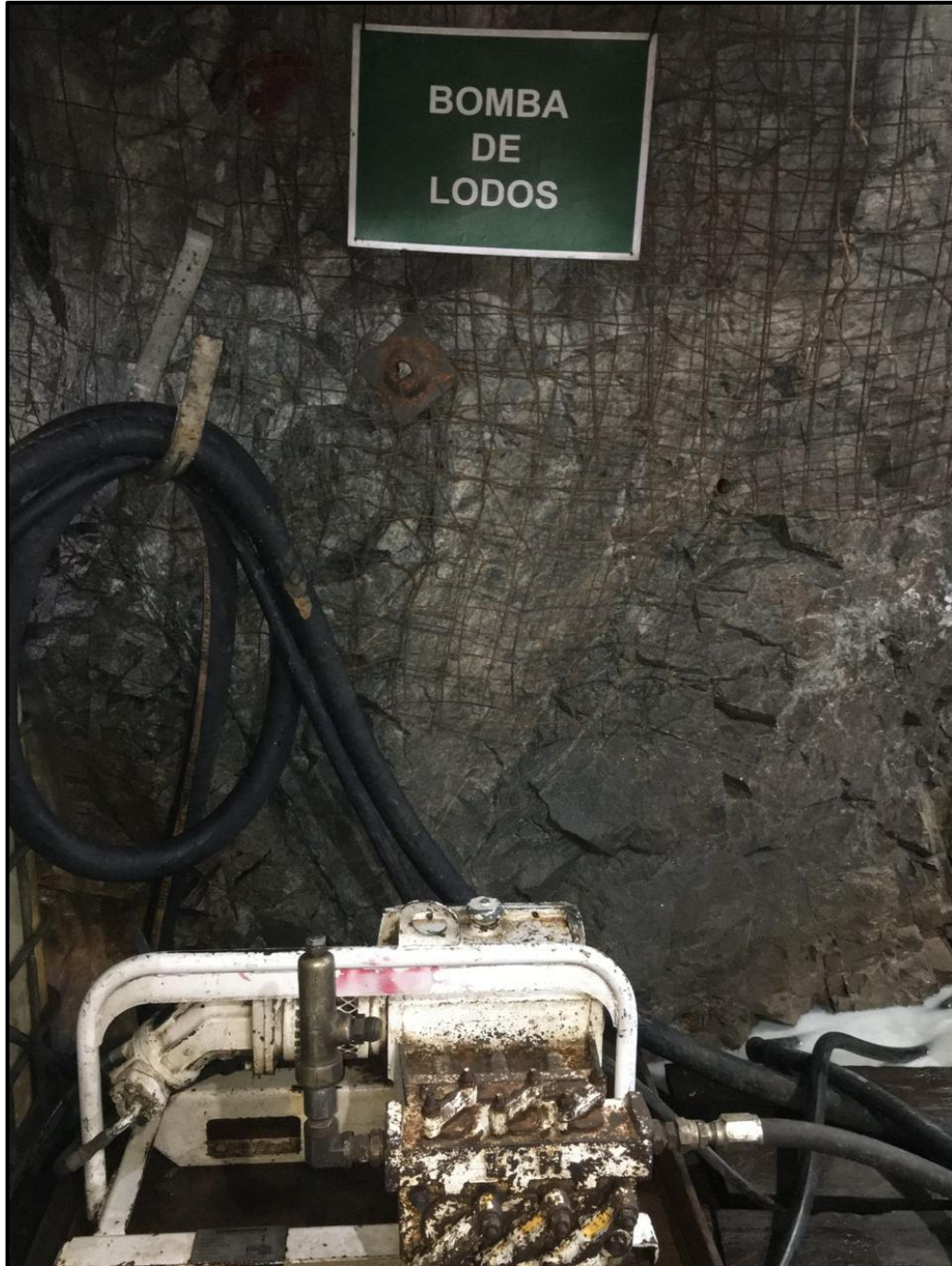
Figura 11: Equipo de Bombeo de Lodos.
