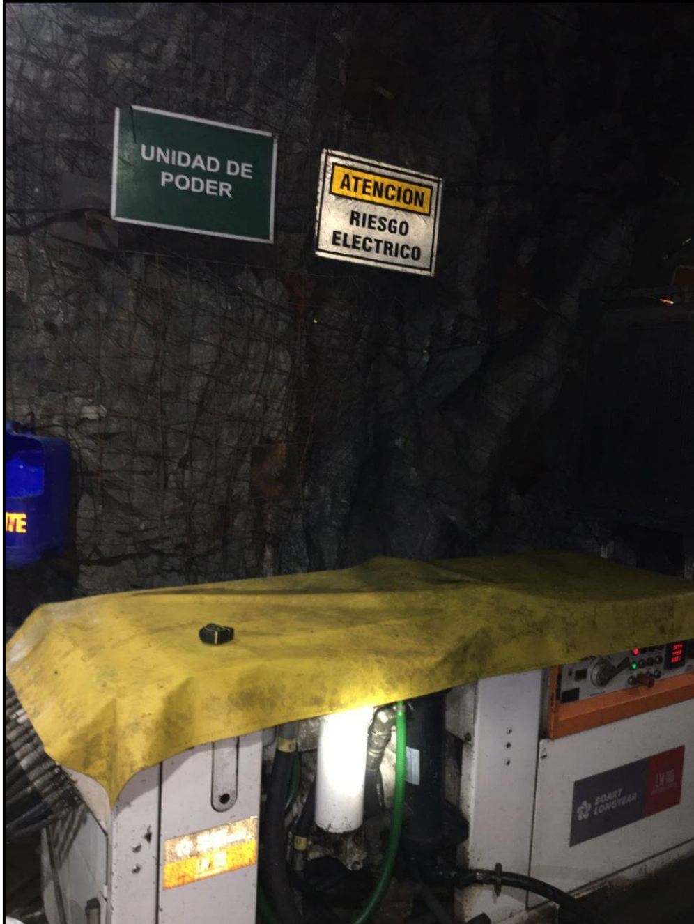
Figura 13: Equipo de poder para alimentación eléctrica.
