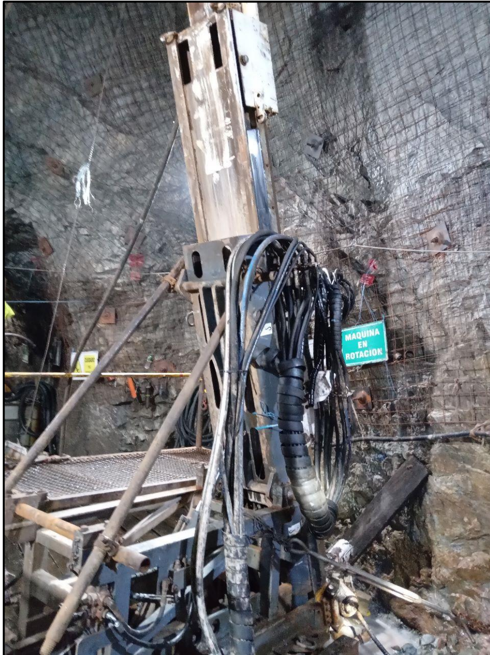
Figura 7: Bastidor de Perforación.
