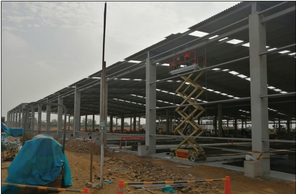
Ilustración 49: Habilitación y colocación de perfiles Tipo C para fijación de cobertura lateral
