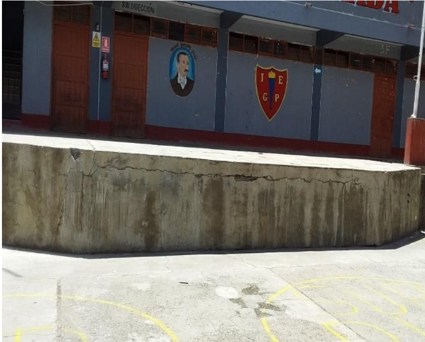
Figura 22. Escenario fisurado y en mal estado
