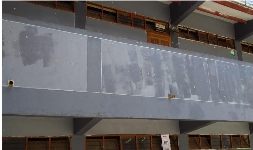
Figura 24. Pabellones sin mantenimiento
