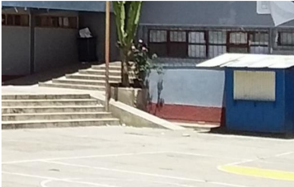
Figura 23. Rampas con pendientes muy pronunciadas
