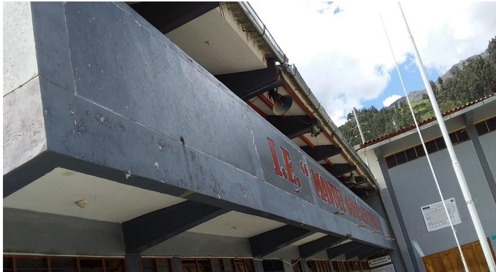
Figura 25. Pabellones sin mantenimiento
