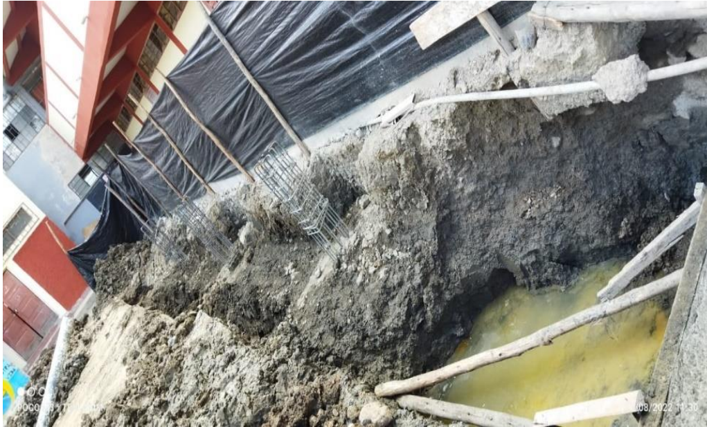
Figura 50. Nivel freático alto a nivel de cimentación.
