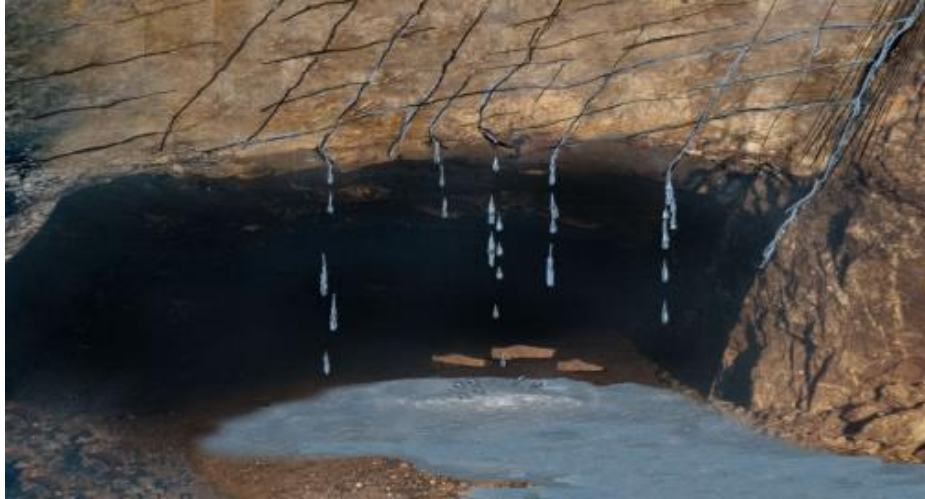
Figura 6: Presencia de agua en el túnel
