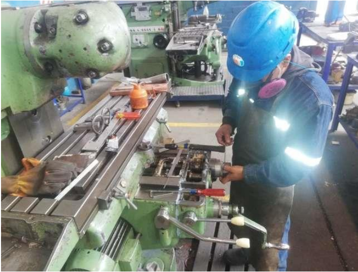
Figura 32. Reparación de manivelas fresadora número 1.
