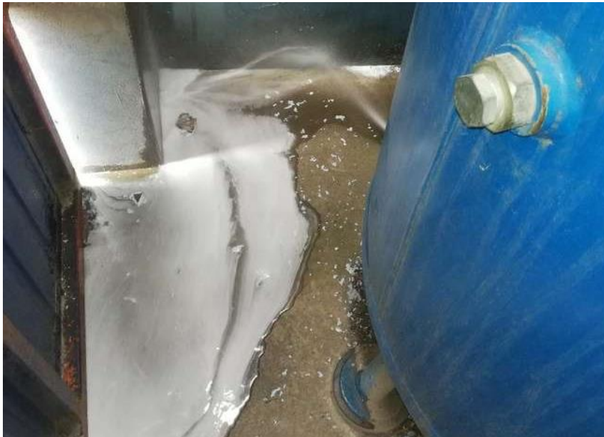
Figura 47. Excesiva cantidad de agua en el tanque de compresora número 2 por falta de purgado del equipo.
