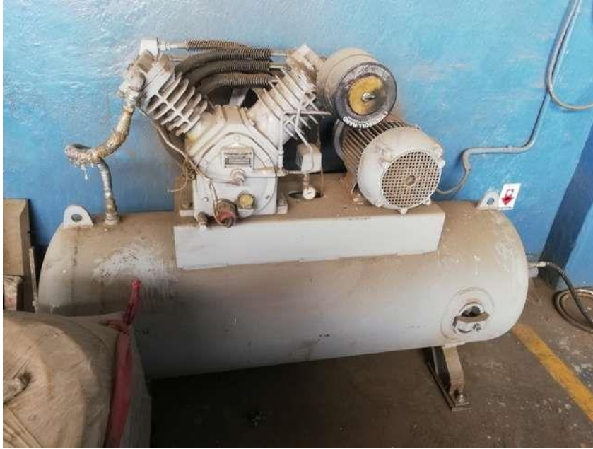
Figura 46. Cañería de carga de compresora número 1 en mal estado, además de falta de limpieza del equipo.
