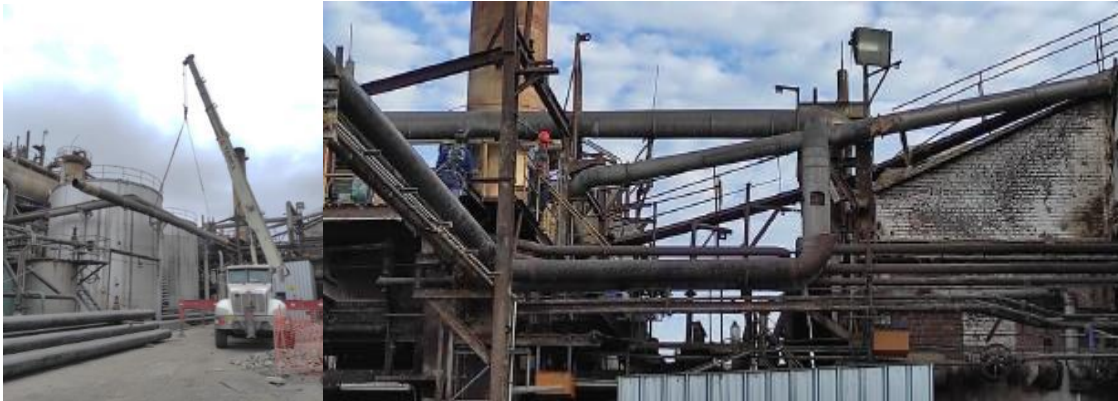
Figura 26. Tubería para reemplazo – Planta alcohol.
