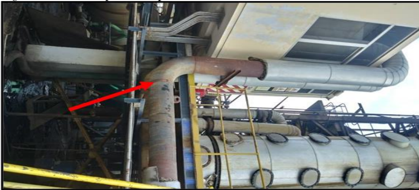
Figura 24. Tubería para reemplazo – Planta alcohol.
