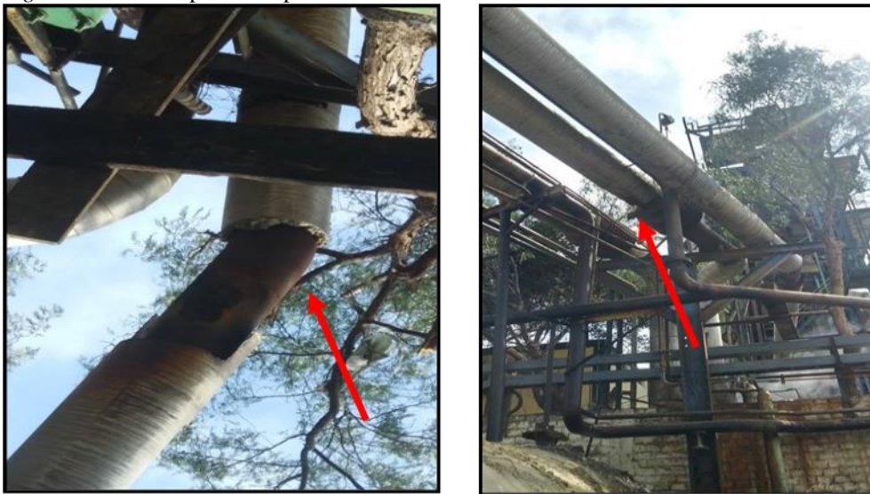
Figura 23. Tubería para reemplazo – Planta alcohol
