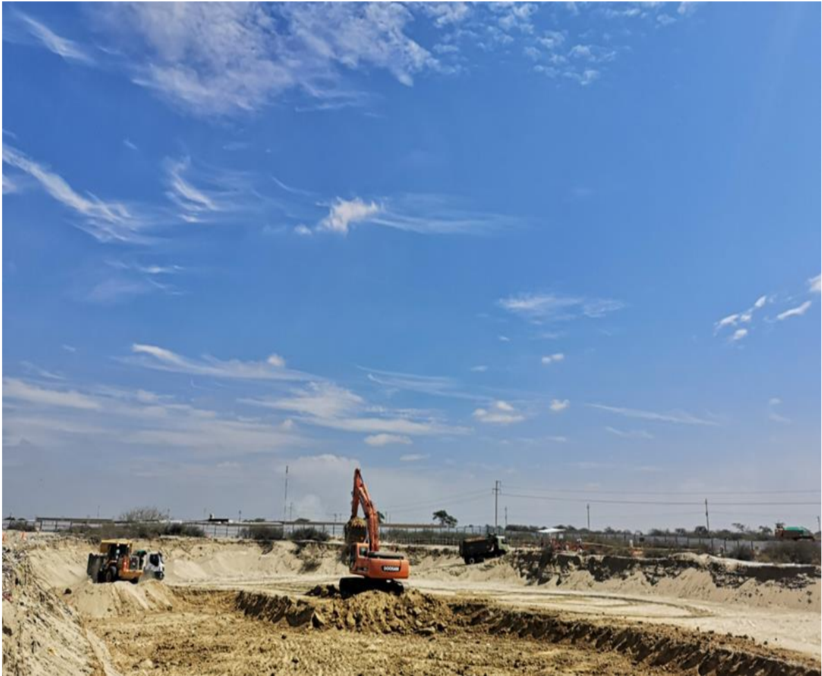
Figura 10. Excavaciones en la huella del edificio con fines de cimentación Fuente: Propia (2022)
