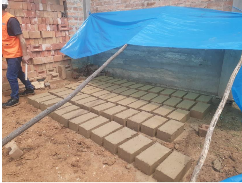
Figura 34. Unidades de adobe elaborados con la adición de humo de sílice condensado con los diferentes porcentajes en estudio.
