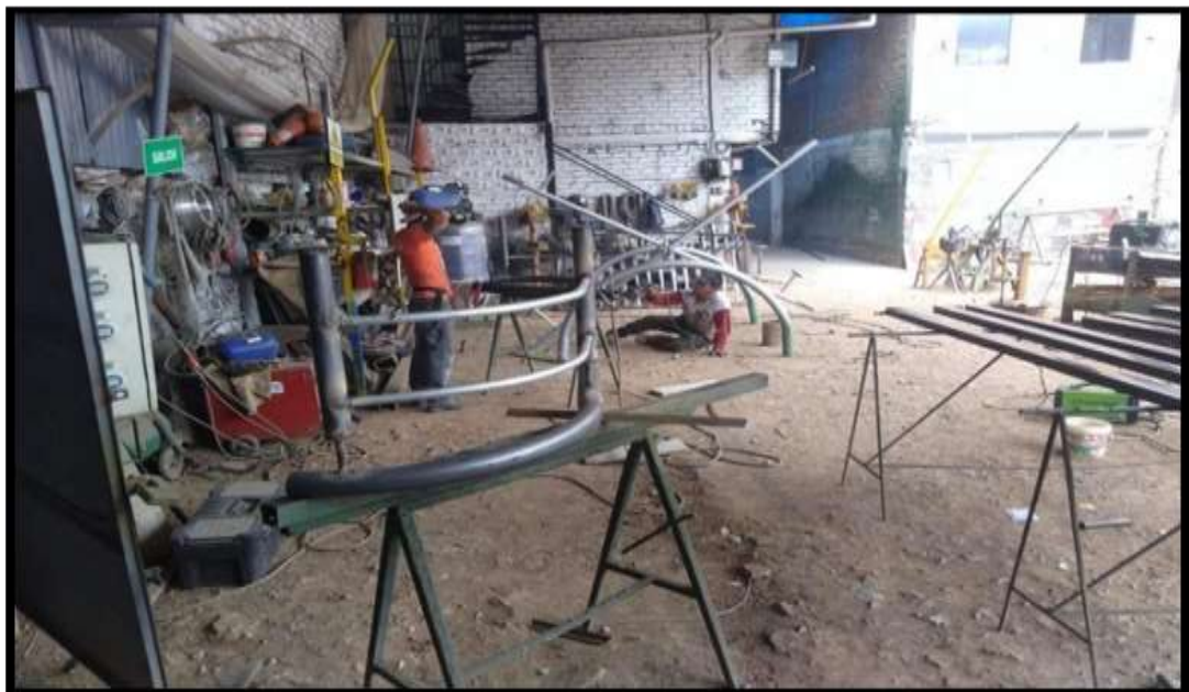
Instalaciones de planta
