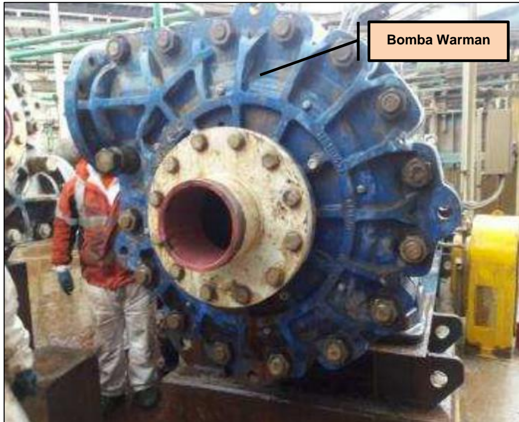
Figura 17: Bomba Warman de la planta.
