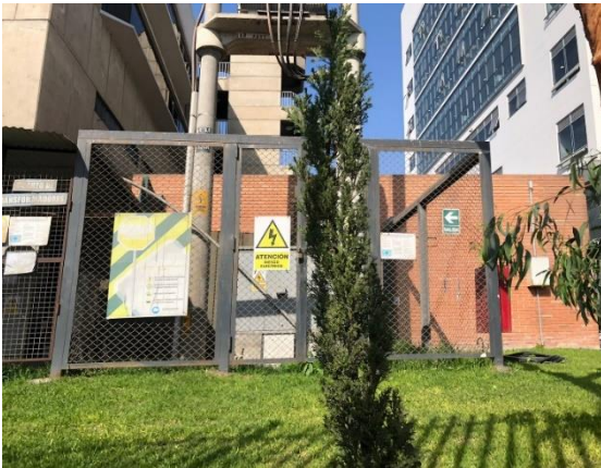
Zona de alta tensión
