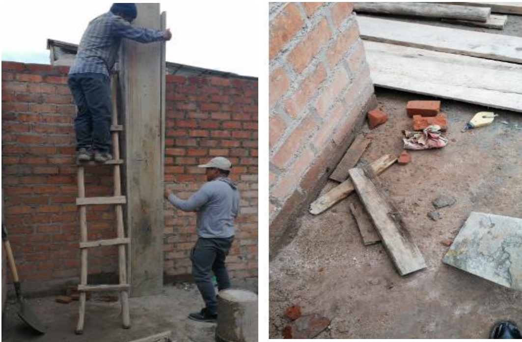
Obra 9: Encofrado y desperdicio de madera en columna
