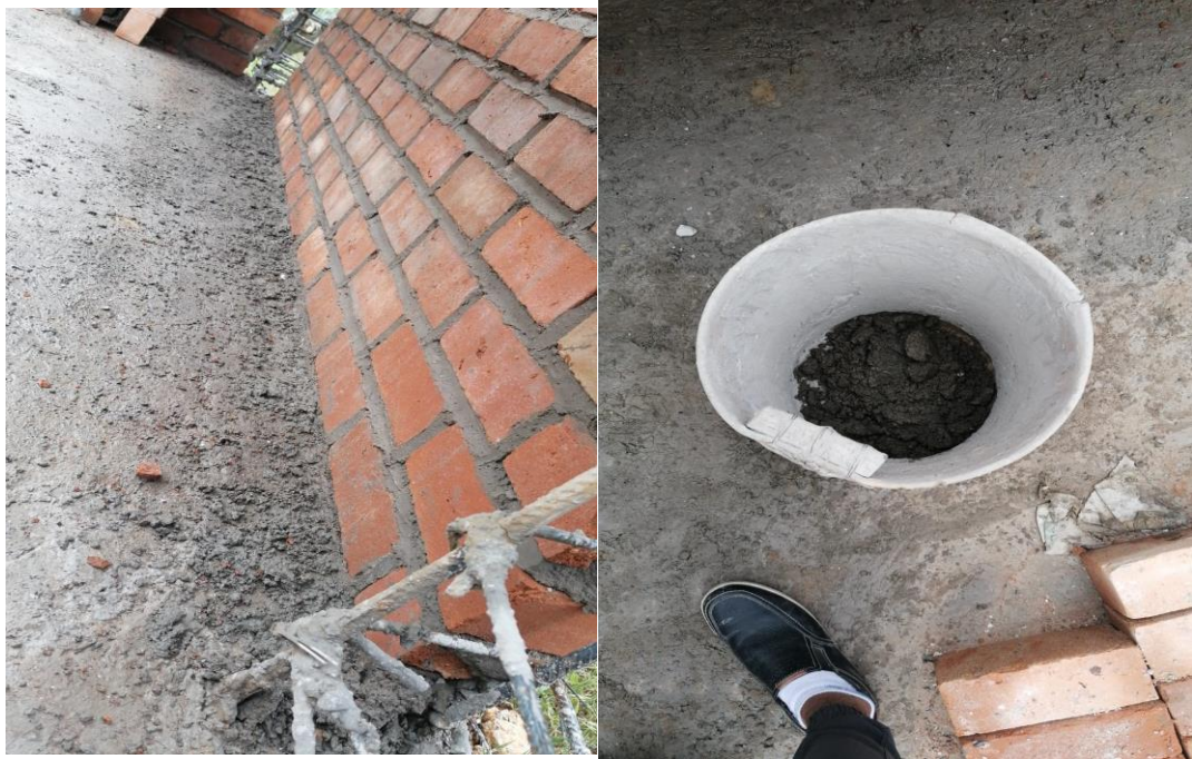
Obra 10: Desperdicio de mortero
