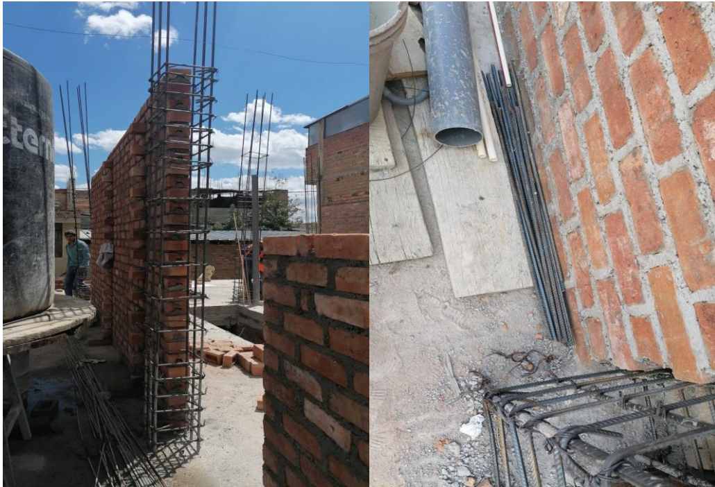
Obra 2: Acero de columna central y desperdicio de acero
