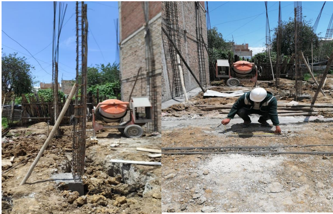
Obra 4: Acero en columna y desperdicio
