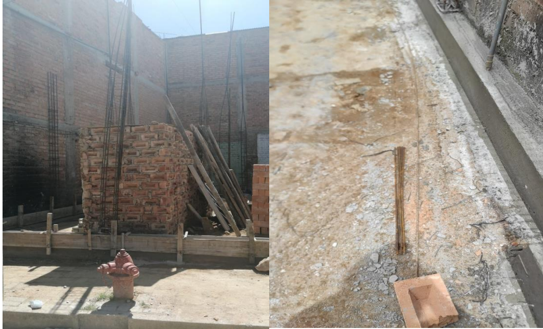
Obra 1: Acero en columna y su desperdicio de acero
