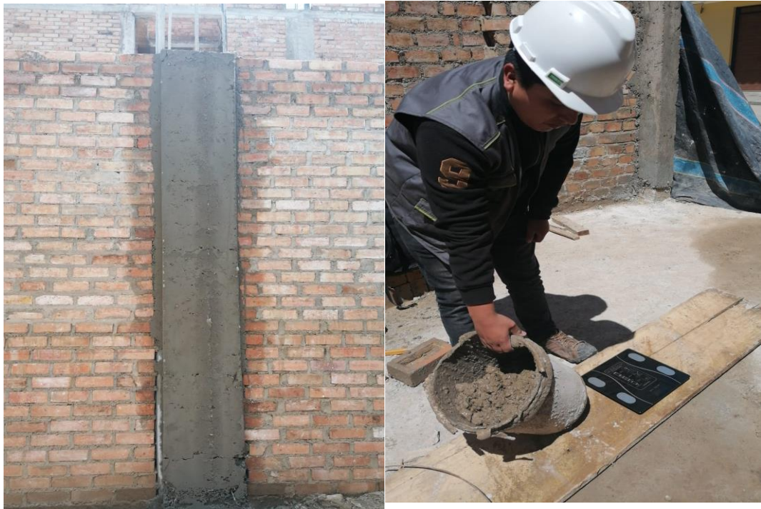
Obra 5: Llenado de columna y desperdicio de concreto
