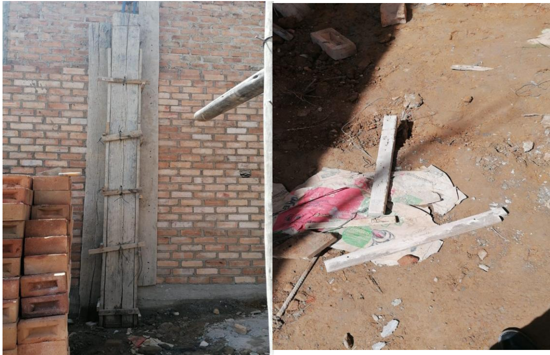
Obra 11: Encofrado de columna y desperdicio
