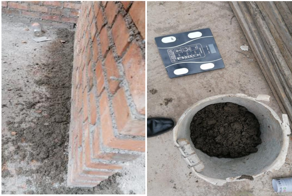
Obra 9: Desperdicio de mortero
