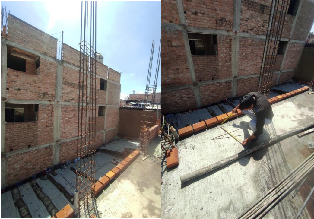
Obra 9: Acero en columna y desperdicio
