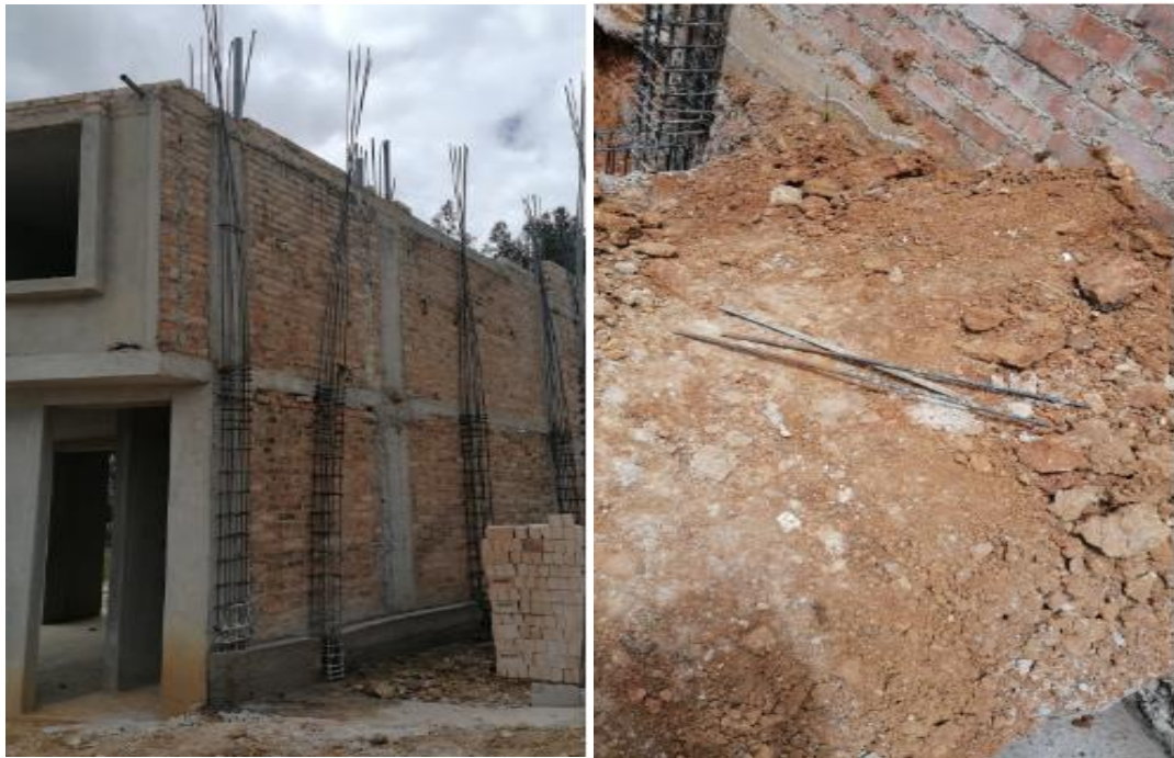
Obra 11: Acero en columna y desperdicio
