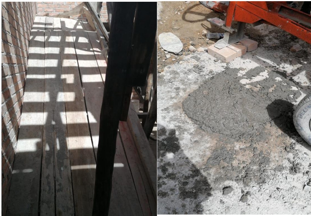
Obra 10: Encofrado en escalera y desperdicio de concreto
