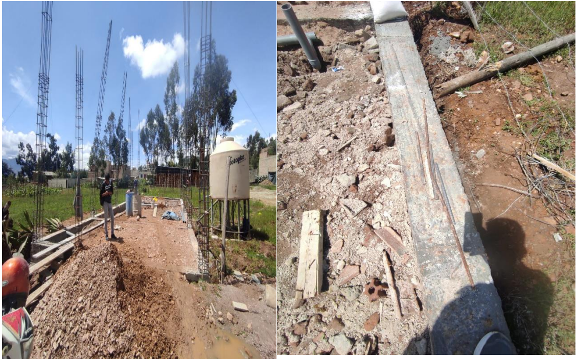
Obra 10: Acero en columnas y desperdicio
