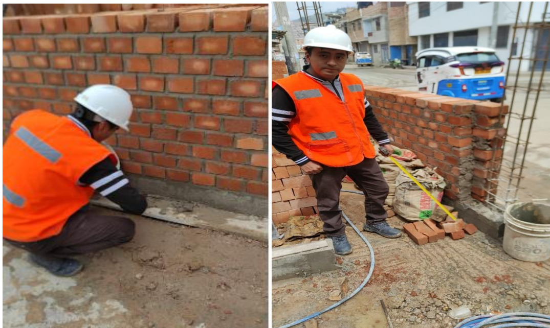
Obra 1: Desperdicio de mortero y ladrillo en asentado de cabeza
