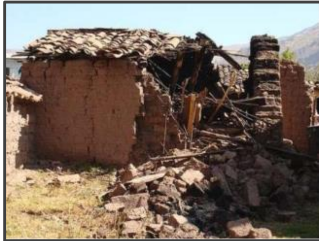
Figura 1: Muestra el colapso de viviendas de adobe producidas por el terremoto de Pisco, 15 de agosto del 2007 Perú.
