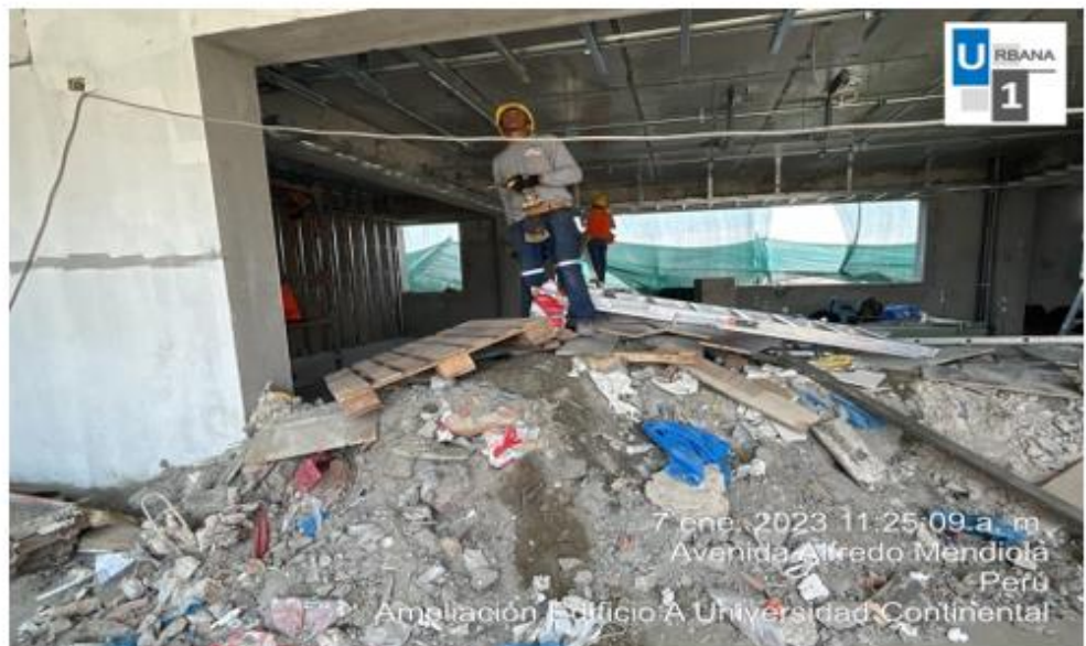
Foto N°9: Se tenía mucha acumulación de material excedente (desmonte) en los pisos 8 y 9.
