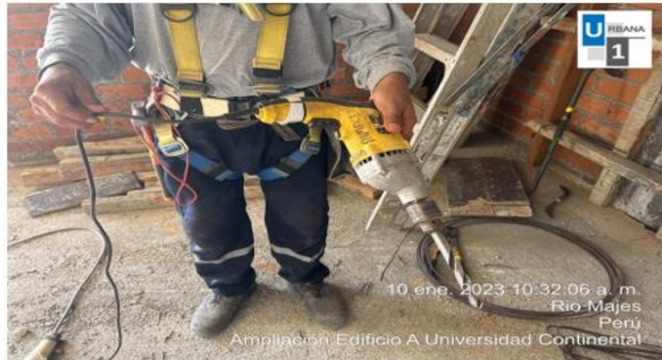
Foto N°6: Taladro en campo sin la cinta del mes de seguridad, en el área de carpintería.
