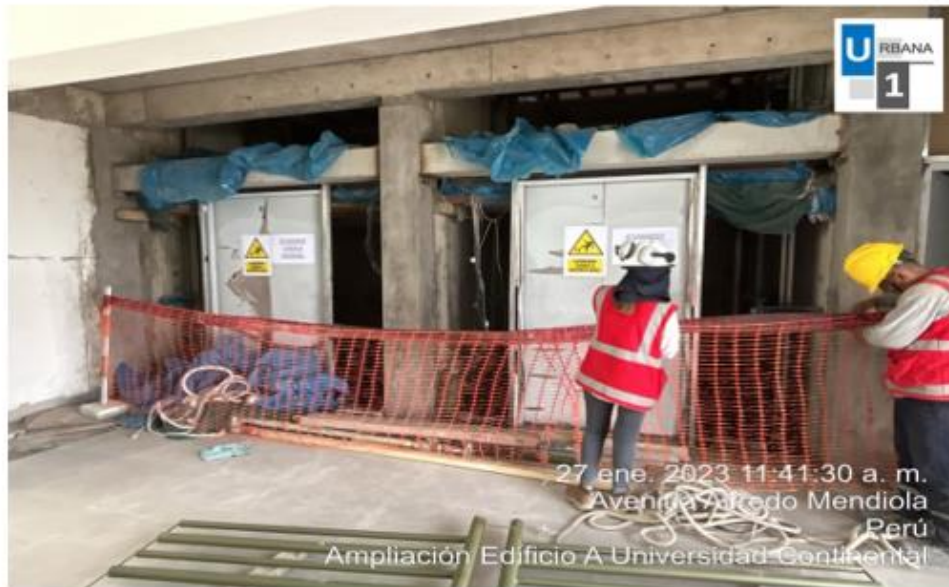
Foto N°18: delimitación de área por posible caída a desnivel
