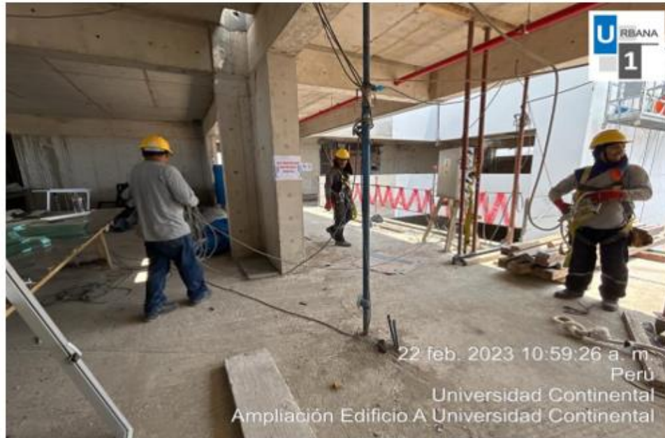
Foto N°23: orden de cables piso 12
