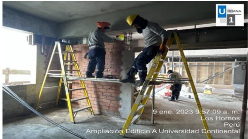
Foto N°2: Inspección de escaleras para su buen uso, se solicitó al personal cambiar las escaleras por andamios.
