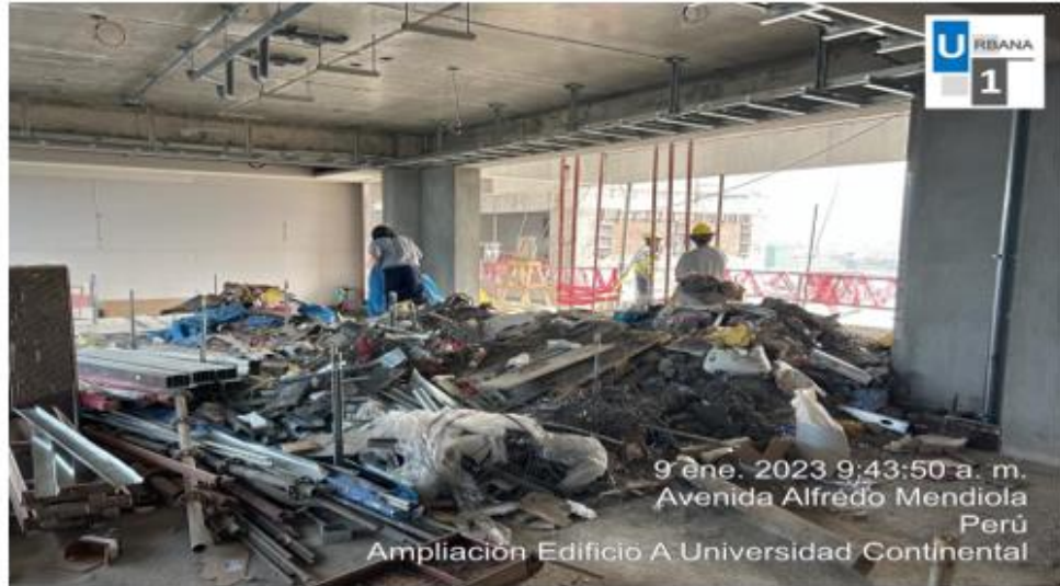
Foto N°10: Se tenía mucha acumulación de material excedente (desmonte) en los pisos 8 y 9.
