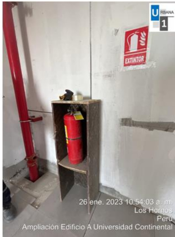
Foto N°9: Inspección de extintor PQS piso 7
