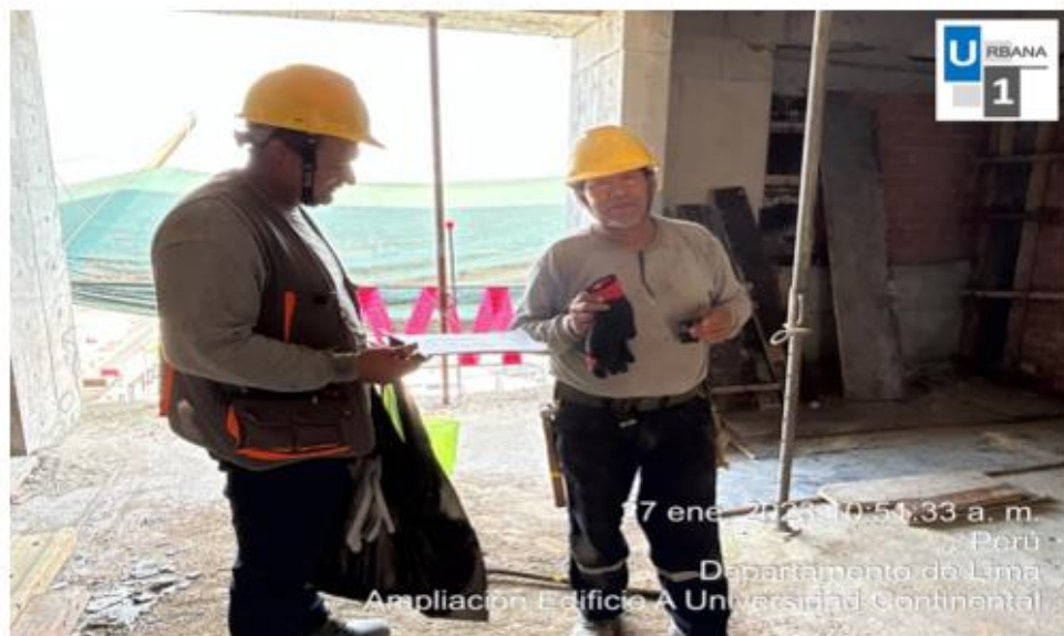
Foto N°15: reposición de guantes piso 10
