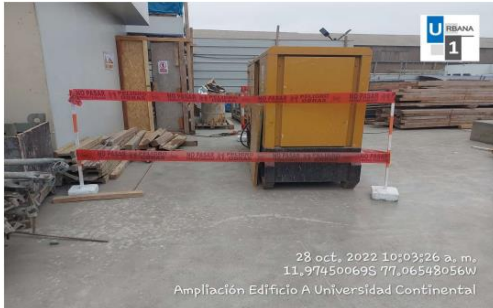
Foto: Señalización grupo electrógeno con cinta de señalización.
