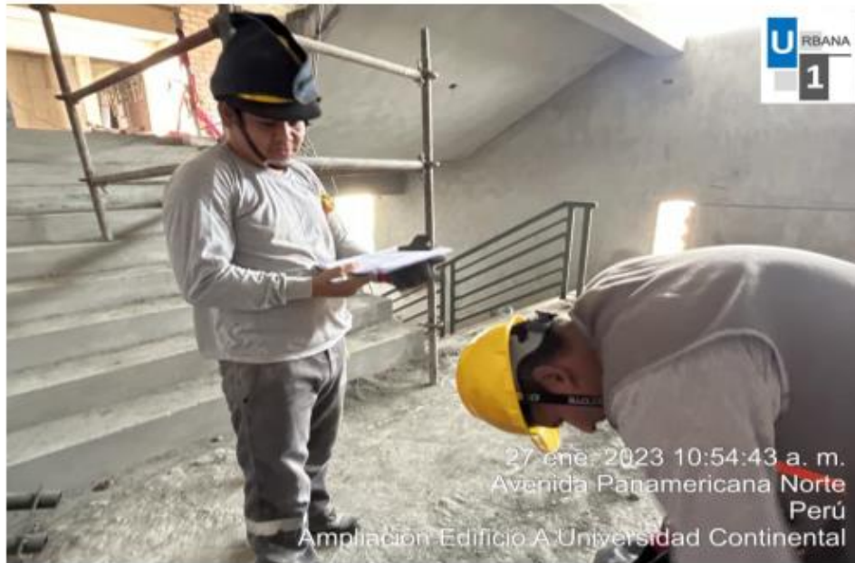
Foto N°16: reposición de guantes piso 12
