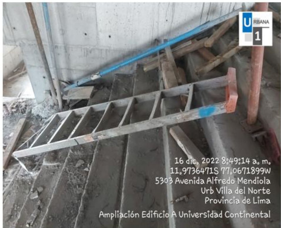
Foto N°1: Inspección de escaleras en obra, se implementó el registro de inspección realizado por SSOMA; las escaleras inoperativas fueron decomisadas.
