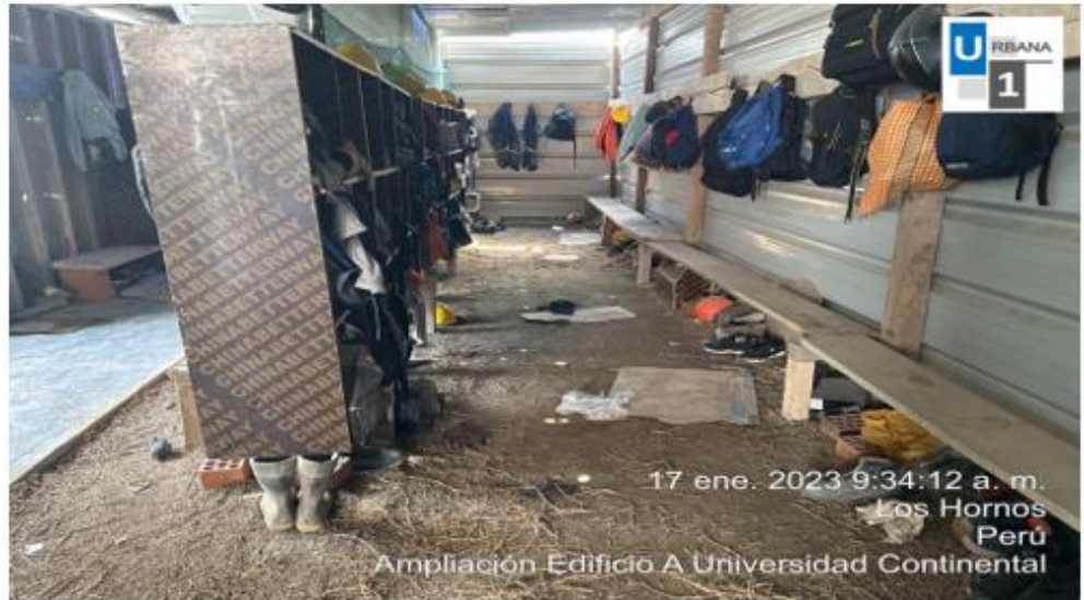
Foto N°8: El personal no viene realizando la limpieza de su área, la limpieza solo lo realizan los monitores de seguridad.
