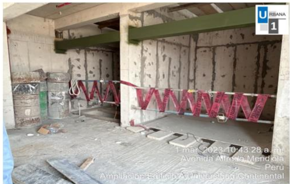
Foto N°6: Verificación de señalización
