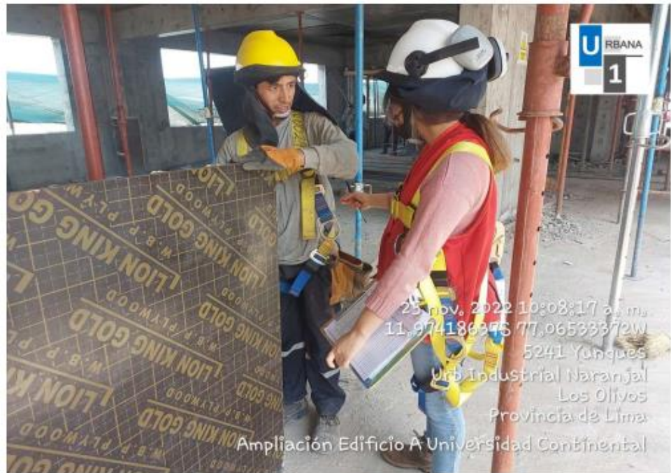
Foto N°1: Inspección de arnés
