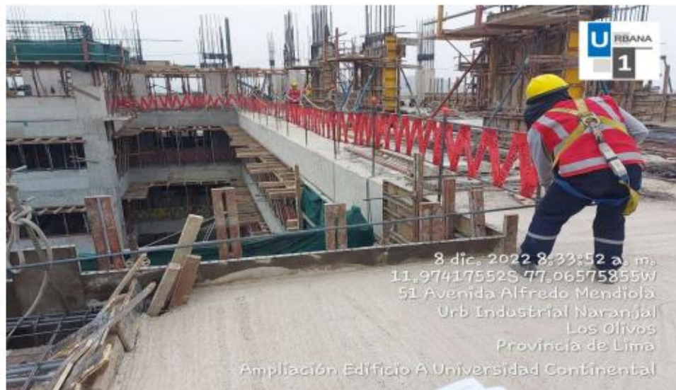
Foto N°9: Señalización de barandas con cinta de seguridad roja.
