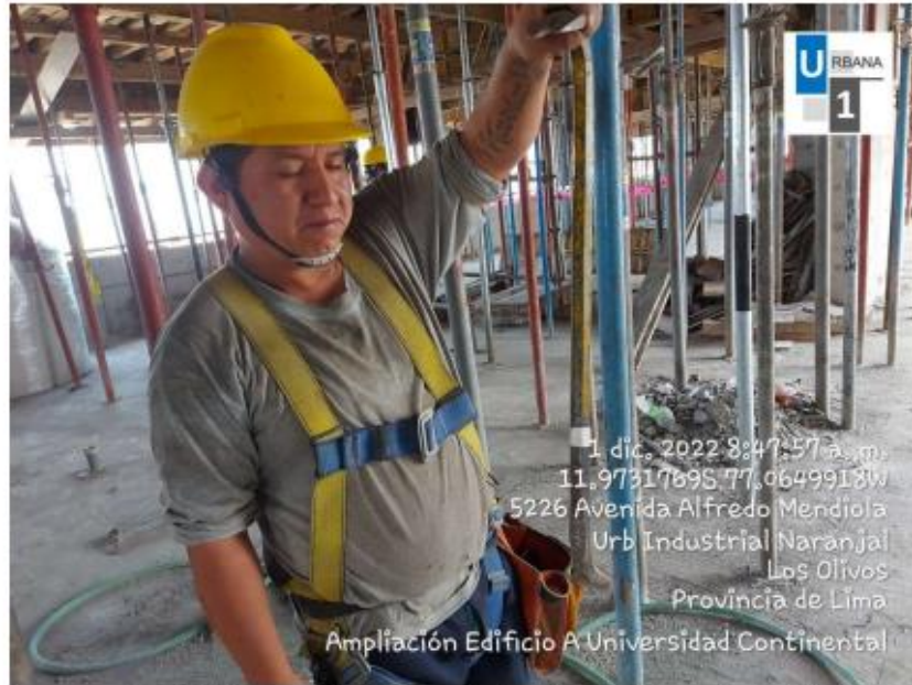
Foto N°2: Inspección de herramienta manual al área de carpintería.
