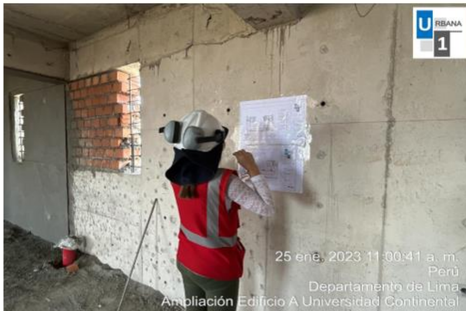
Foto N°17: colocación de mapa de riesgo actualizado y plano de evacuación
