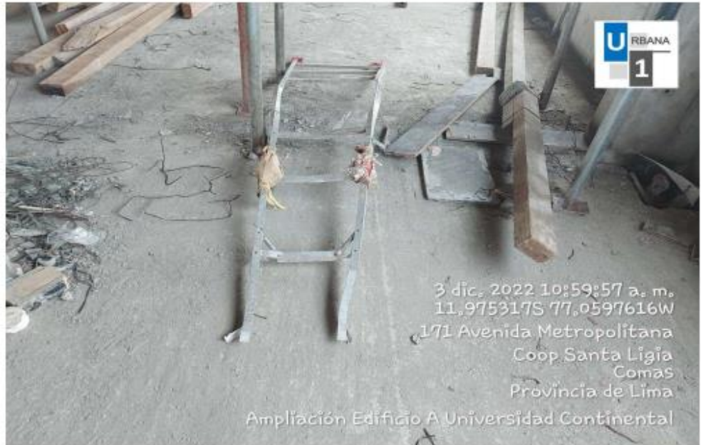
Foto N°4: Inspección de escaleras, se solicitó el retiro de obra.
