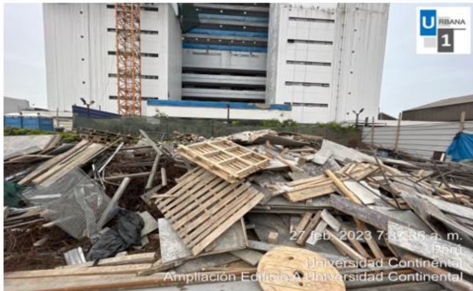
Foto N°26: tenemos en el patio de maniobras la acumulación de material de madera entre otros residuos, ya tenemos una NC por orden y limpieza.
