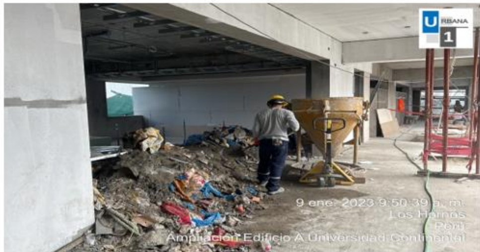
Foto N°11: Se tenía mucha acumulación de material excedente (desmonte) en los pisos 9 y 10.
