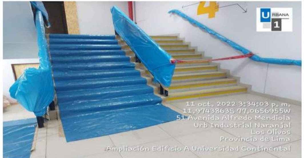
Foto: Forrado de barandas y escaleras para una mejor conservación y señalización peatonal.
