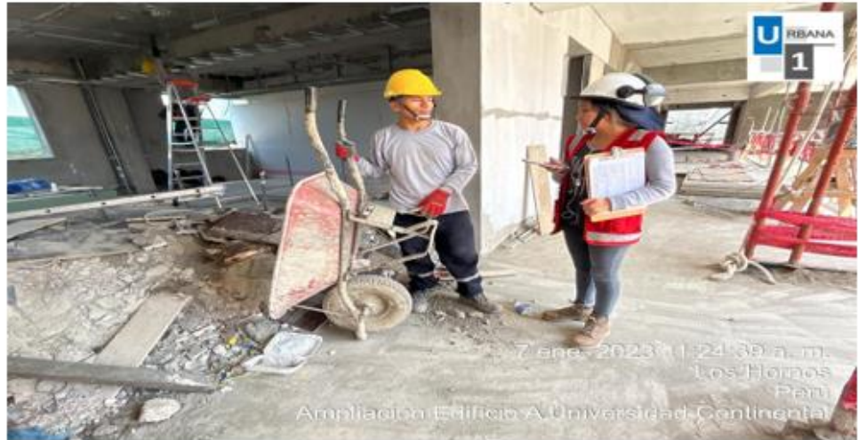
Foto N°4: Mediante inspección de herramientas se verificó que la carretilla se encontraba para mantenimiento o retiro de obra al estar en malas condiciones.
