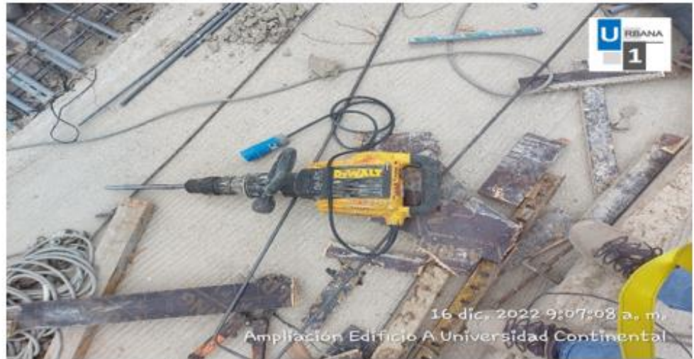
Foto N°2: Inspección de herramienta manual, rotomartillo sin cinta del mes de seguridad.
