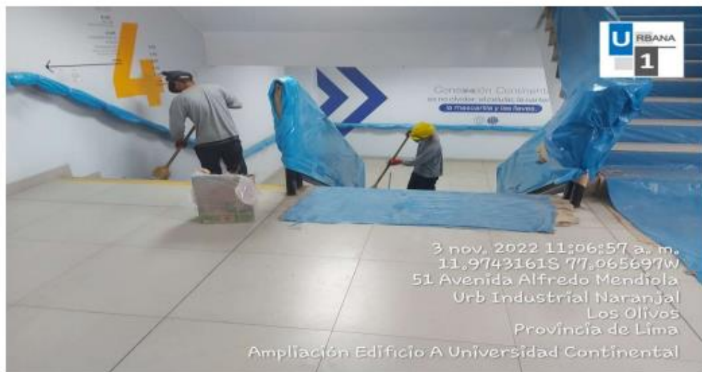
Foto N°5: Orden y limpieza de escaleras y señalización.
