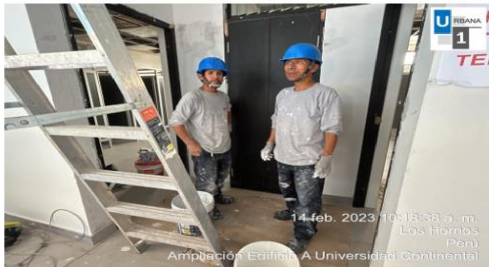
Foto N°9: Inspección de EPP
