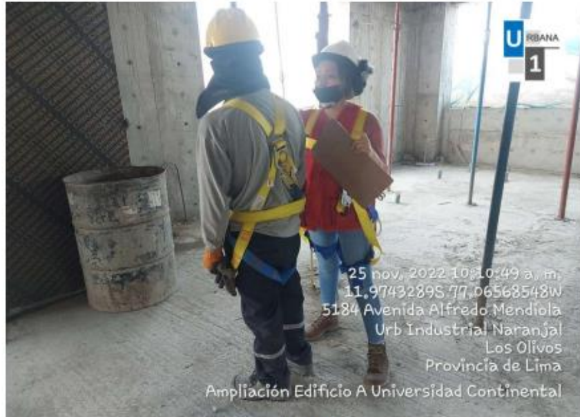
Foto N°2: Inspección de arnés
