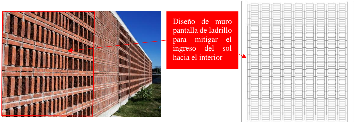
Figura 13: presencia de muro pantalla. fuente: Mariana Cecilio, 2016. Intervención con color rojo para identificar el uso de muro pantalla como filtro de ingreso solar
