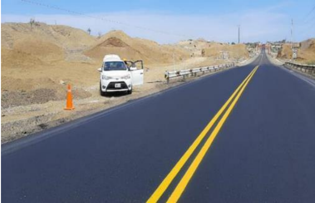
Foto 1 - Marcas en el pavimento Km 320+220 Tramo 2 – Carretera Panamericana norte
