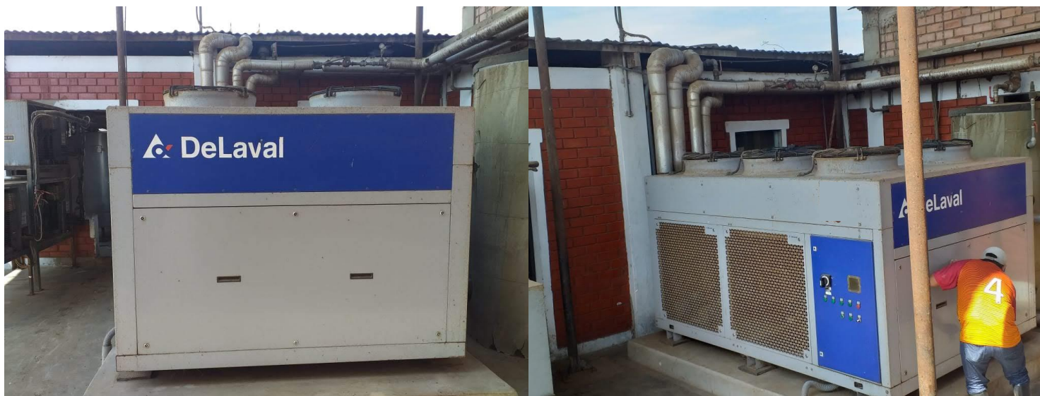
Figura 9. Chiller de enfriamiento De Laval, vista lateral y perspectiva (Registro fotográfico de la empresa).
