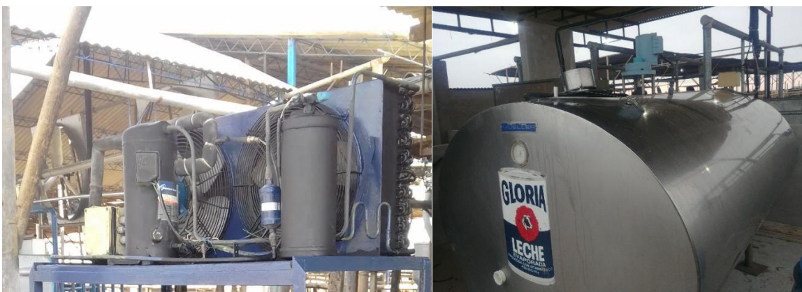
Figura 8. Izquierda-Tanque de enfriamiento MUELLER de 1000Galones/Derecha-Unidad condensadora ELGIN para tanque de enfriamiento.
