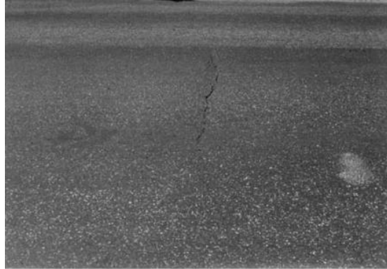
Figura 32 Grietas Longitudinales y Transversales de severidad baja
