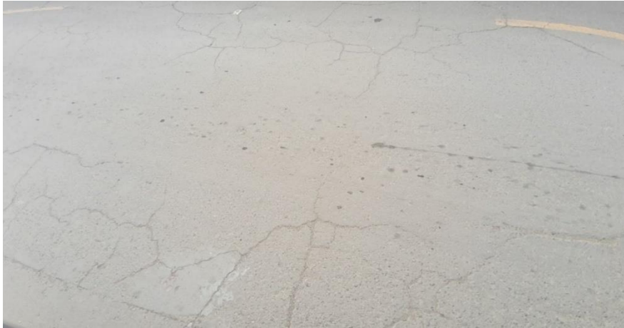
Figura 151 Presencia de grietas longitudinales y transversales en la vía
