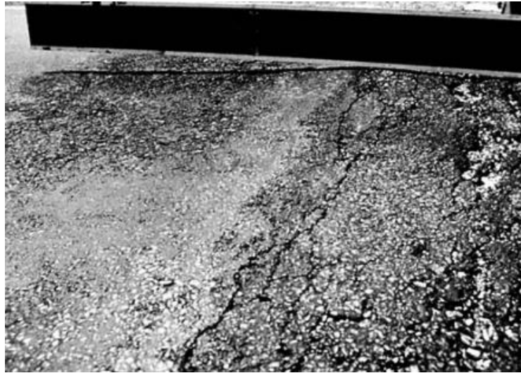
Figura 16 Abultamientos y Hundimientos de severidad alta
