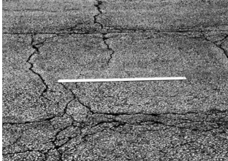
Figura 11 Agrietamiento en bloque de severidad baja
