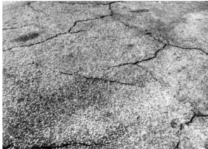
Figura 13 Agrietamiento en bloque de severidad alta
