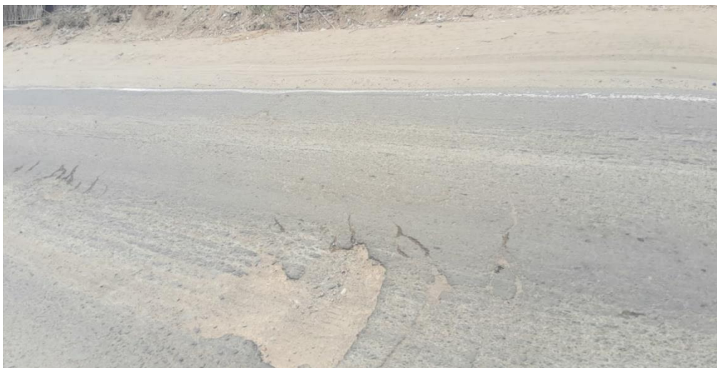
Figura 152 Presencia de huecos y desprendimientos de agregados
