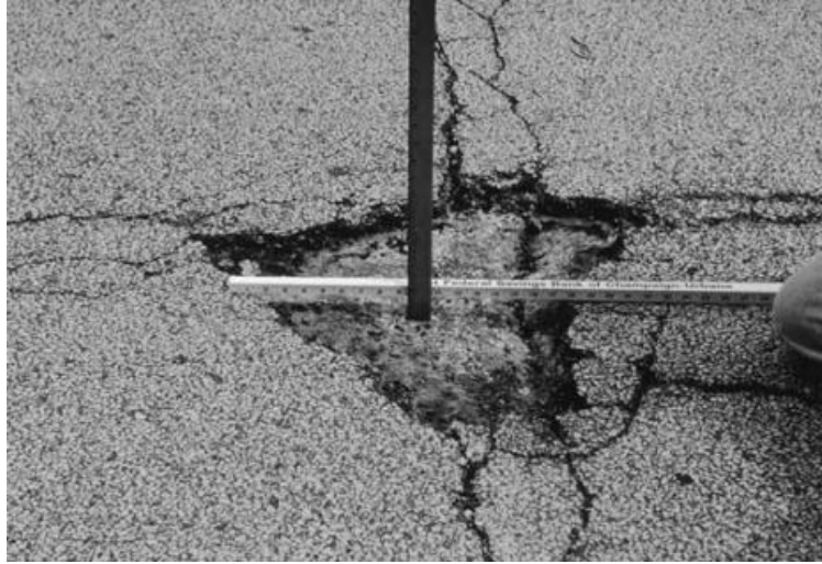
Figura 40 Huecos de severidad media
