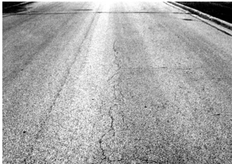
Figura 5 Piel de cocodrilo de severidad baja
