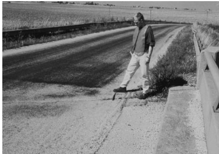
Figura 48 Desplazamiento de severidad baja
