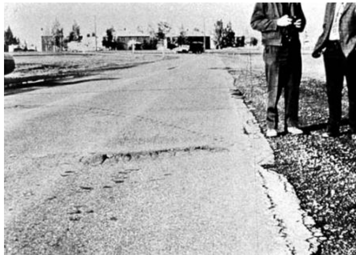
Figura 15 Abultamientos y Hundimientos de severidad media
