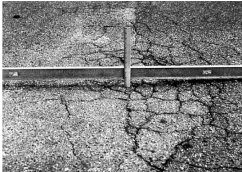
Figura 22 Depresión de severidad alta
