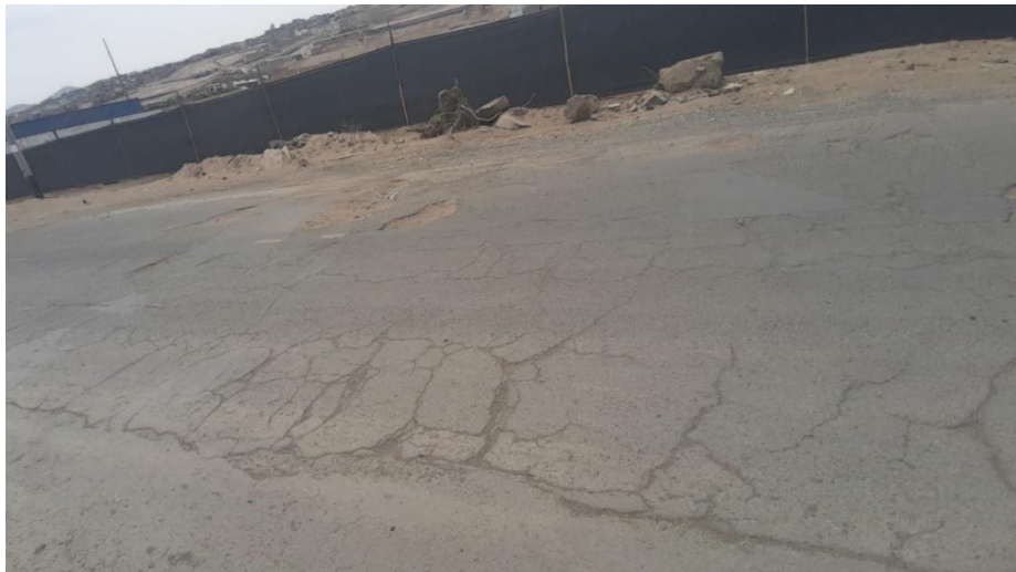
Figura 154 Presencia de huecos, piel de cocodrilo y grietas longitudinales y transversales en la vía
