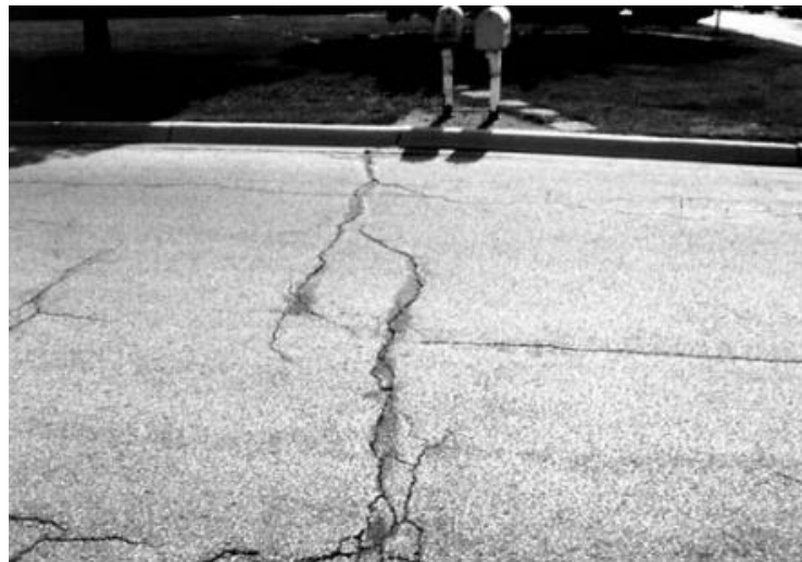
Figura 12 Agrietamiento en bloque de severidad media
