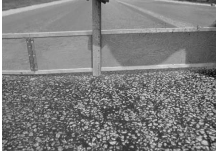
Figura 46 Ahuellamiento de severidad media
