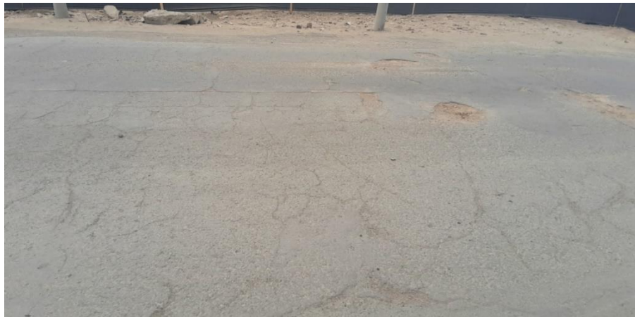
Figura 153 Presencia de huecos y piel de cocodrilo
