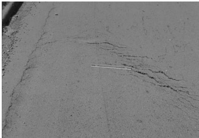
Figura 52 Grietas Parabólicas de severidad media
