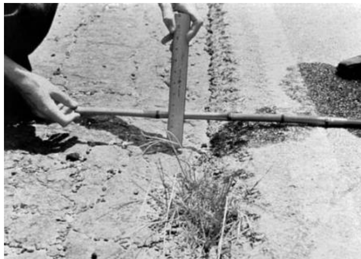
Figura 30 Desnivel Carril / Berma de severidad media
