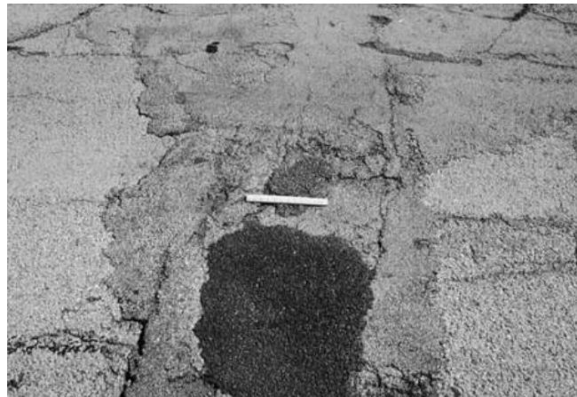
Figura 37 Parqueo y acometidas de servicios públicos de severidad alta
