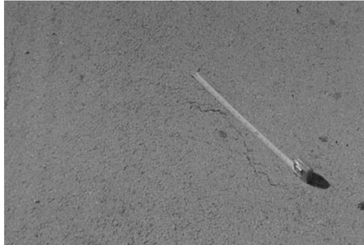
Figura 51 Grietas Parabólicas de severidad baja
