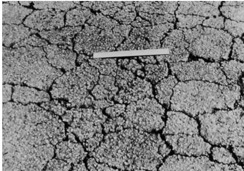
Figura 7 Piel de cocodrilo de severidad alta
