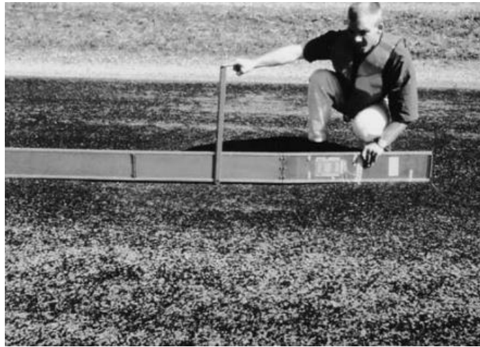
Figura 20 Depresión de severidad baja
