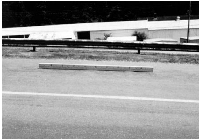
Figura 18 Corrugación de severidad media
