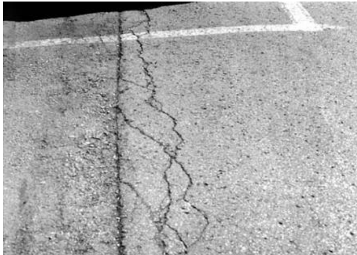
Figura 24 Grieta de Borde de severidad media
