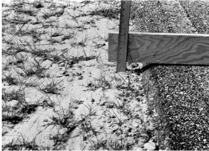
Figura 29 Desnivel Carril / Berma de severidad baja
