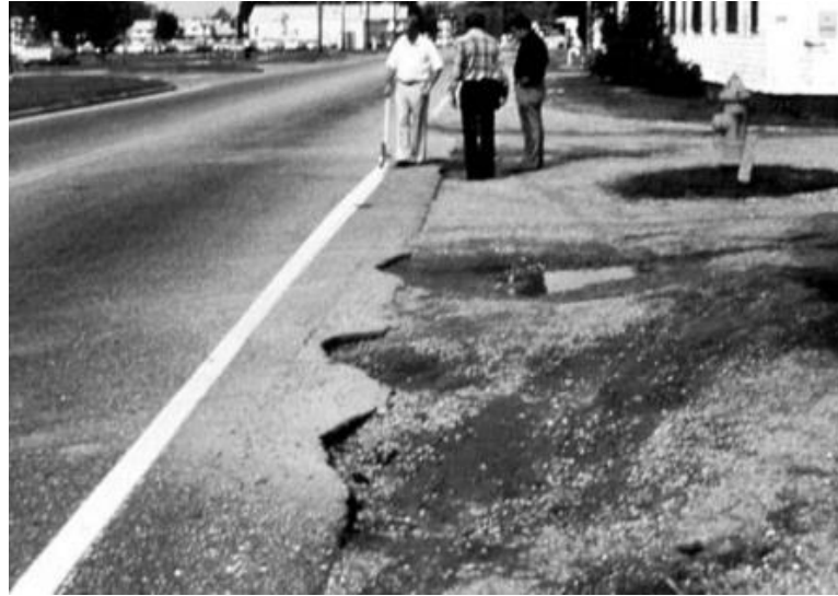
Figura 25 Grieta de Borde de severidad alta
