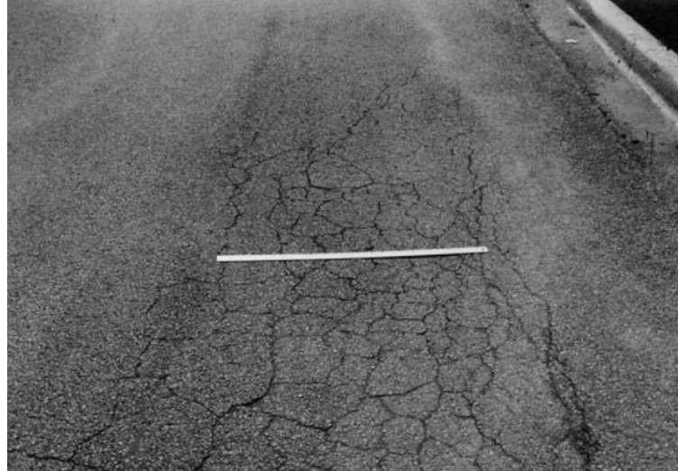
Figura 6 Piel de cocodrilo de severidad media
