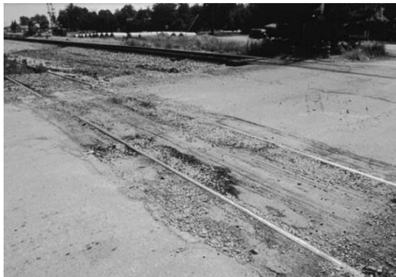
Figura 44 Cruce de Vía Férrea de severidad alta
