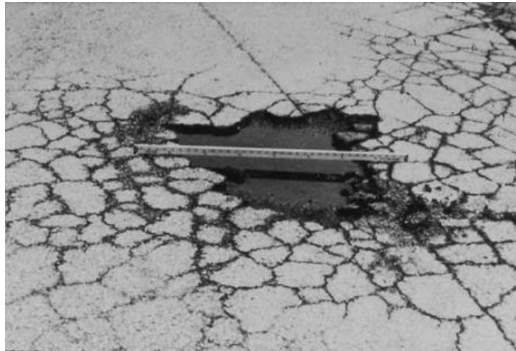
Figura 41 Huecos de severidad alta
