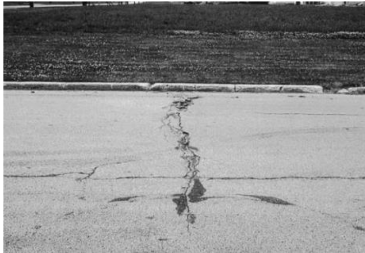
Figura 34 Grietas Longitudinales y Transversales de severidad alta
