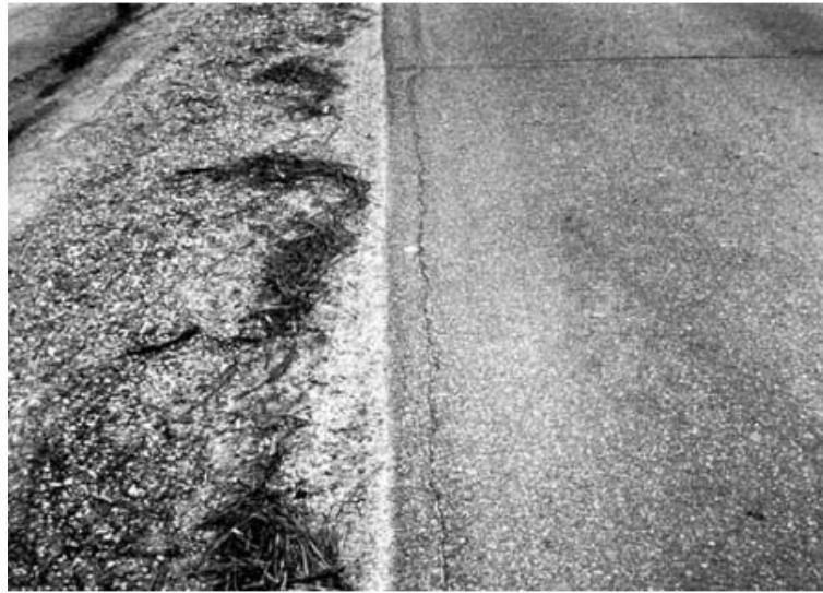
Figura 23 Grieta de Borde de severidad baja
