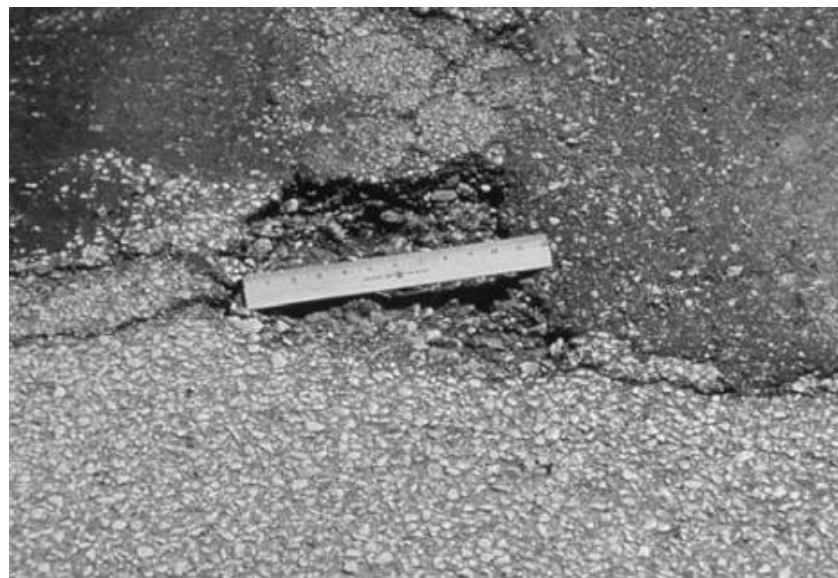
Figura 39 Huecos de severidad baja
