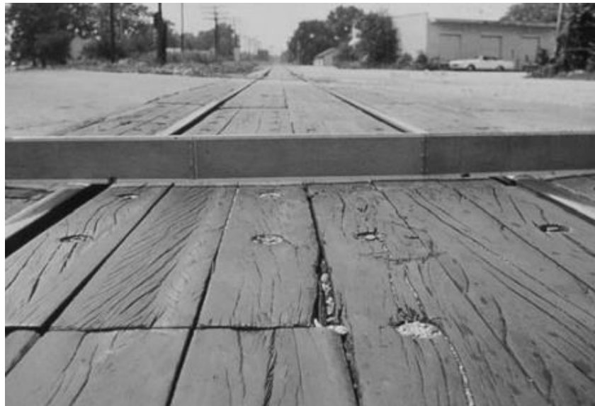
Figura 42 Cruce de Vía Férrea de severidad baja
