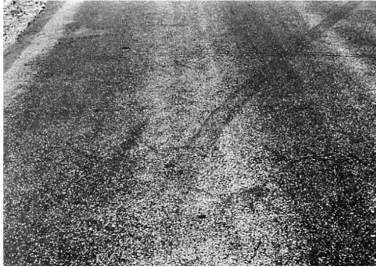
Figura 8 Exudación de severidad baja
