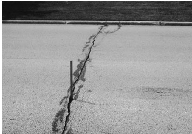
Figura 33 Grietas Longitudinales y Transversales de severidad media
