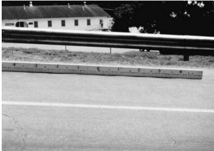
Figura 17 Corrugación de severidad baja
