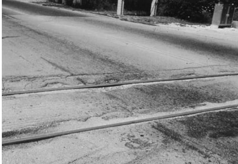
Figura 43 Cruce de Vía Férrea de severidad media
