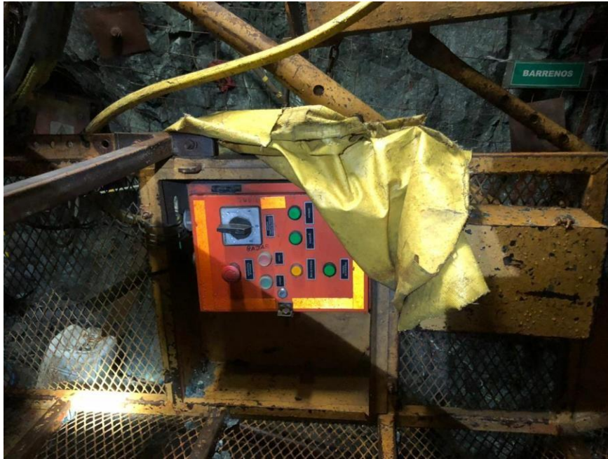
Foto 07: Tablero eléctrico del equipo Alimak
