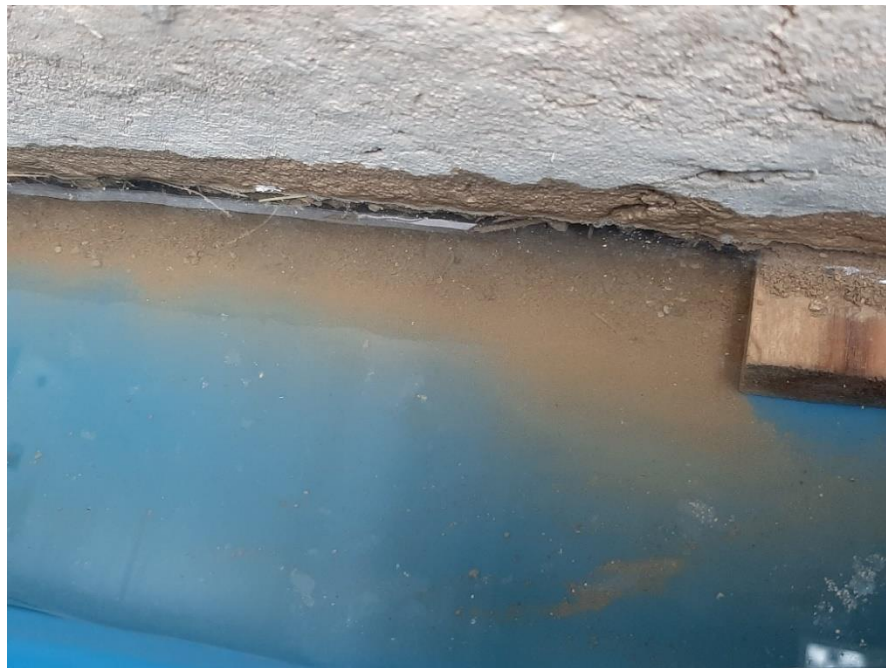
Tierra desprendiéndose del adobe apenas llenando el agua.
