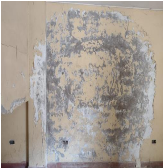
Figura 4. Toma fotográfica de presencia de humedad en muro interior
