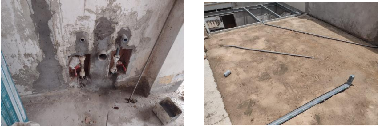
Figura 5. Toma fotográfica de la Instalación de fontanería
