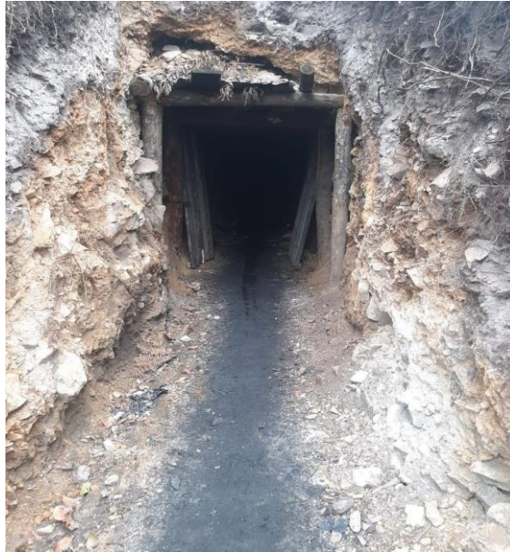
Foto N°1: Bocamina N°1, no presenta drenaje
