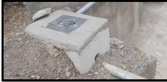
Figura 27 Válvula de aire en el Caserío Yatahual
