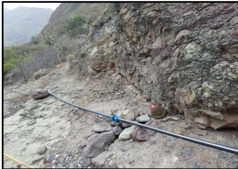
Línea de conducción del Caserío Yatahual
