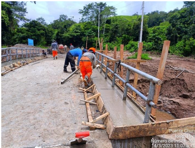
Se observa el vaciado de las veredas y también la colocación de las barandas
