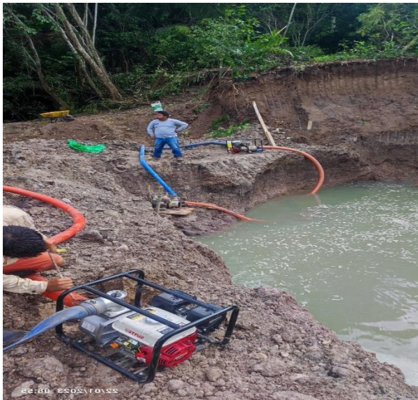
Se observa que se esta utilizando motobomba para eliminar el agua para comenzar con las zapatas.
