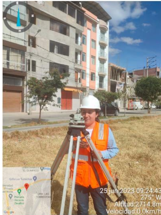
Instalación de GPS Diferencial
