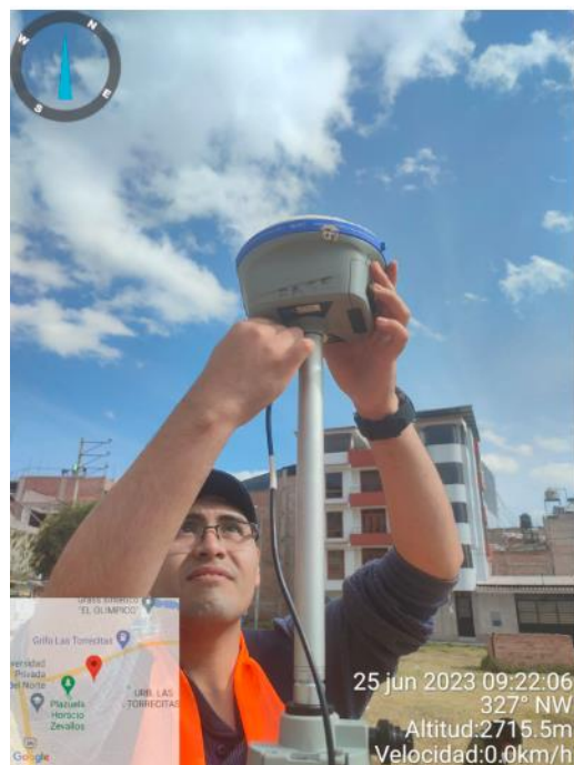
Instalación de GPS Diferencial
