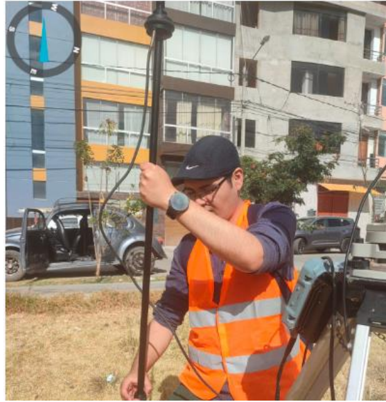
Instalación de GPS Diferencial
