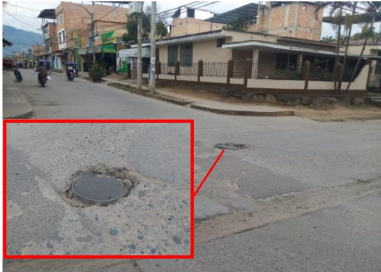
Figura 5. Falla por desintegración de peladuras (MNC MEDIOS, 2021)
