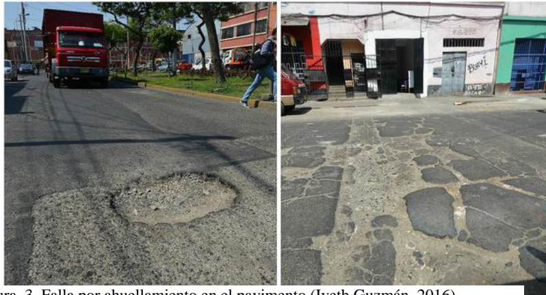
Figura 3. Falla por ahuellamiento en el pavimento (Iveth Guzmán, 2016)
