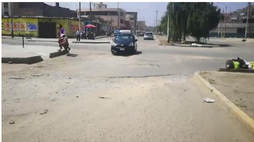
Figura 6. Desintegración por desprendimiento de agregados (Rolando Gonzales, 2019)
