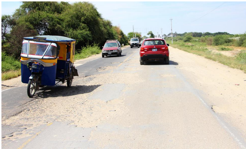
Figura 4. Falla por ahuellamiento y piel de cocodrilo en el pavimento (Ralph Zapata ,2017)
