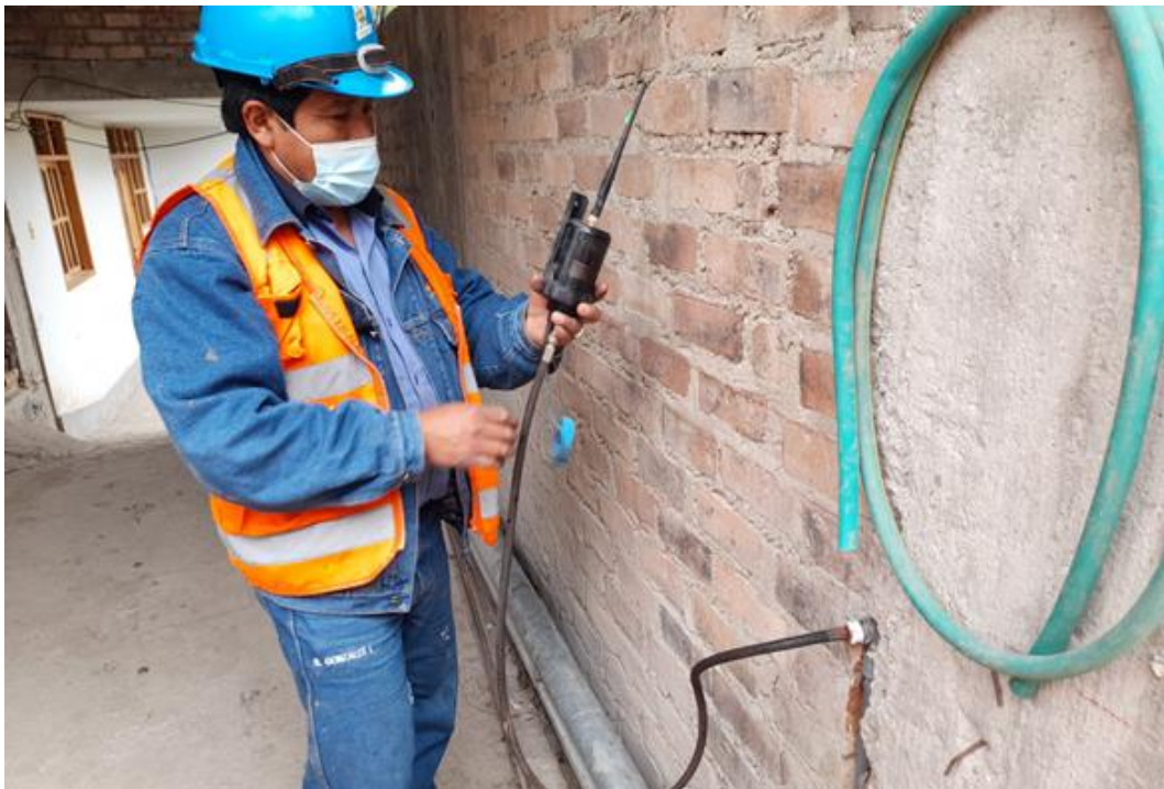
Vista N° 02: Instalación de data logger con personal técnico de la EPS.
