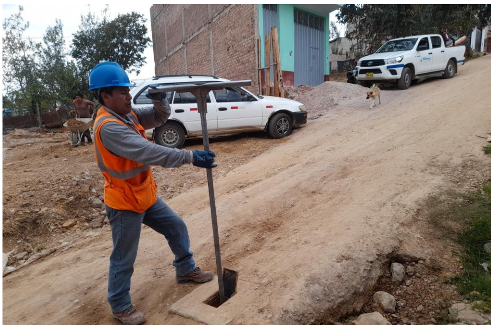
Vista N° 04: Manipulación de válvulas de control (sectorización hidráulica).
