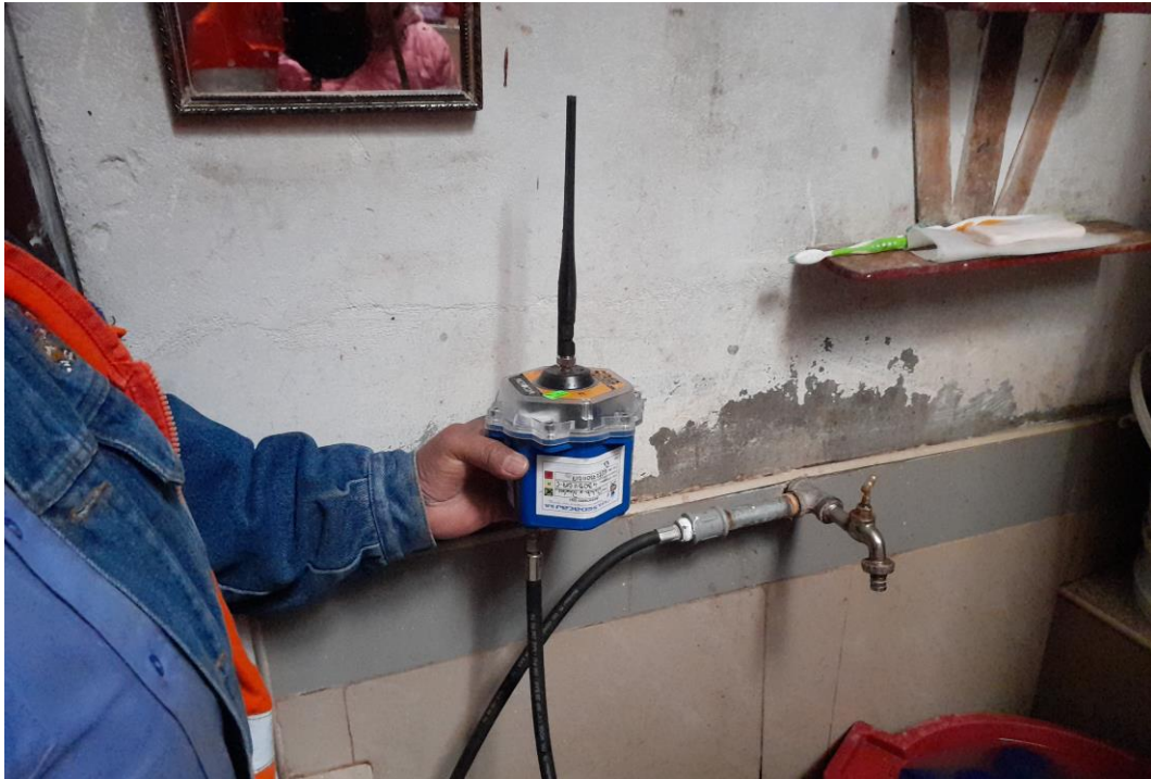
Vista N° 01: Instalación de data logger con personal técnico de la EPS.
