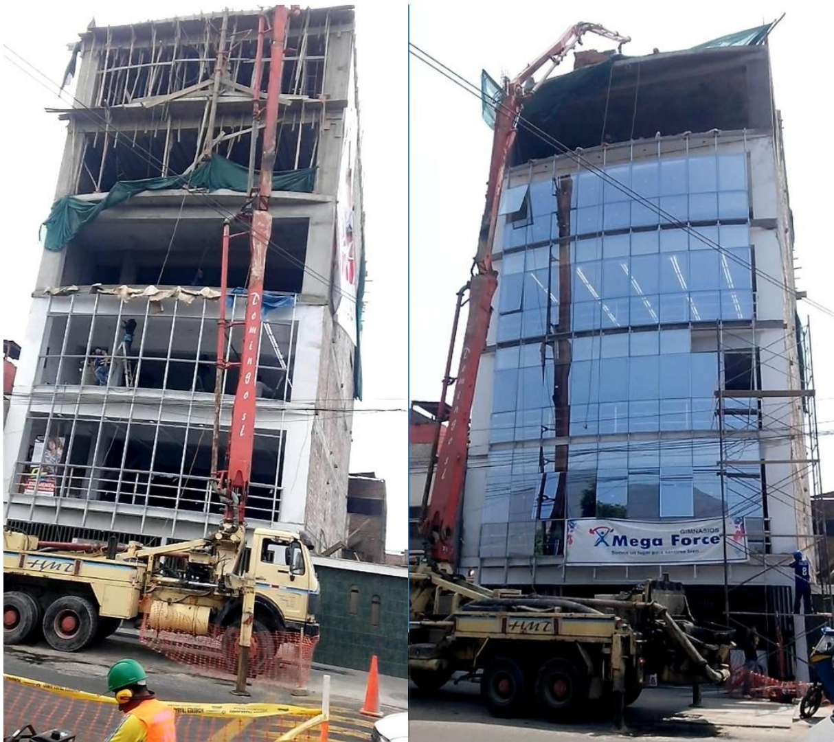
Figura 13. Edificio de gimnasio MEGA FORCE construido con losa aligerada de poliestireno expandido en San Juan de Lurigancho-Lima.
