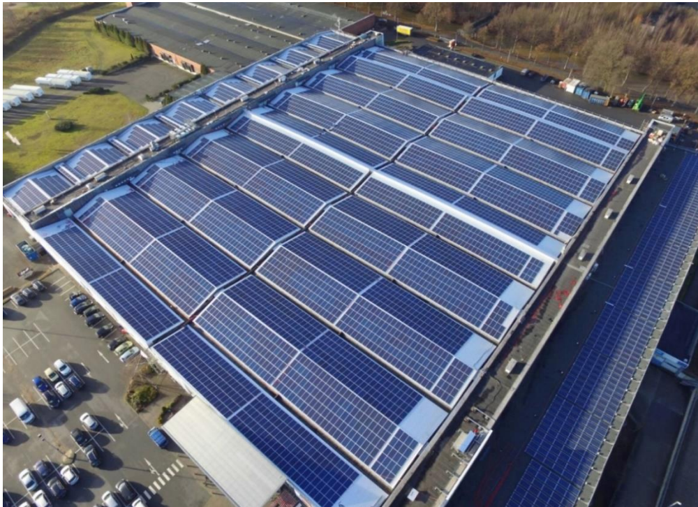
Figura 19. Vista de la cubierta de paneles solares del Centro Comercial Nordhorn
