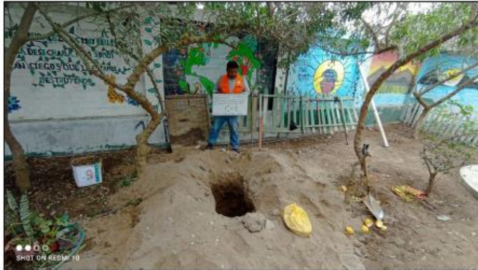
FOTO N° 1: Vista panorámica exterior de la excavación a cielo abierto denominado calicata C-1.
