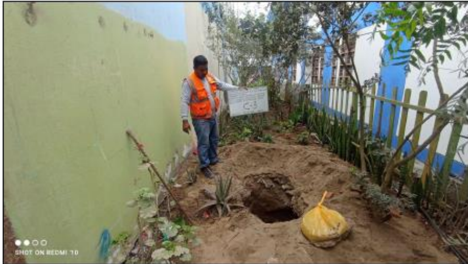
FOTO N° 9: Vista panorámica exterior de la excavación a cielo abierto denominada calicata C-3.
