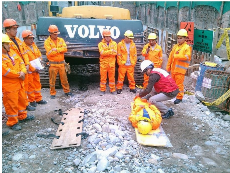
Figura 9: Inducciones de seguridad y accidentes en obra.
