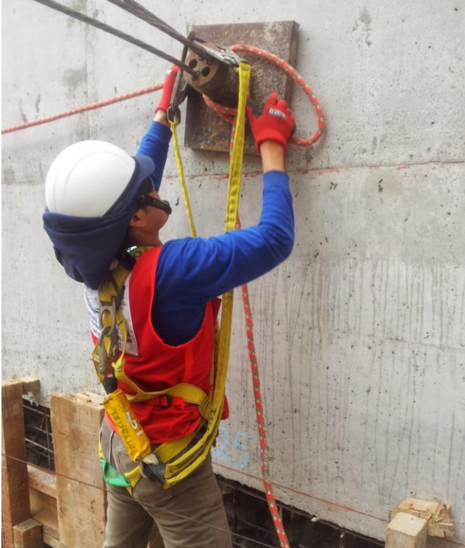
Figura 10: Líneas de vida en dados de los muros pantalla.
