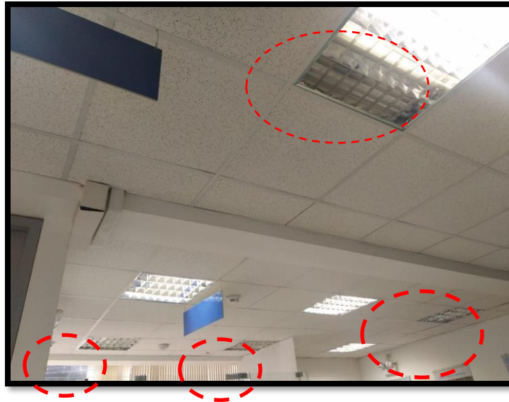
Figura 5. Luminarias fuera de servicio.
