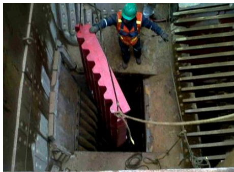
Figura 23: Cambio de ciclones
