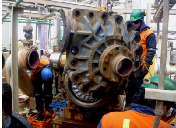
Figura 20: Mantenimiento Mecánico de Bombas y Motores
