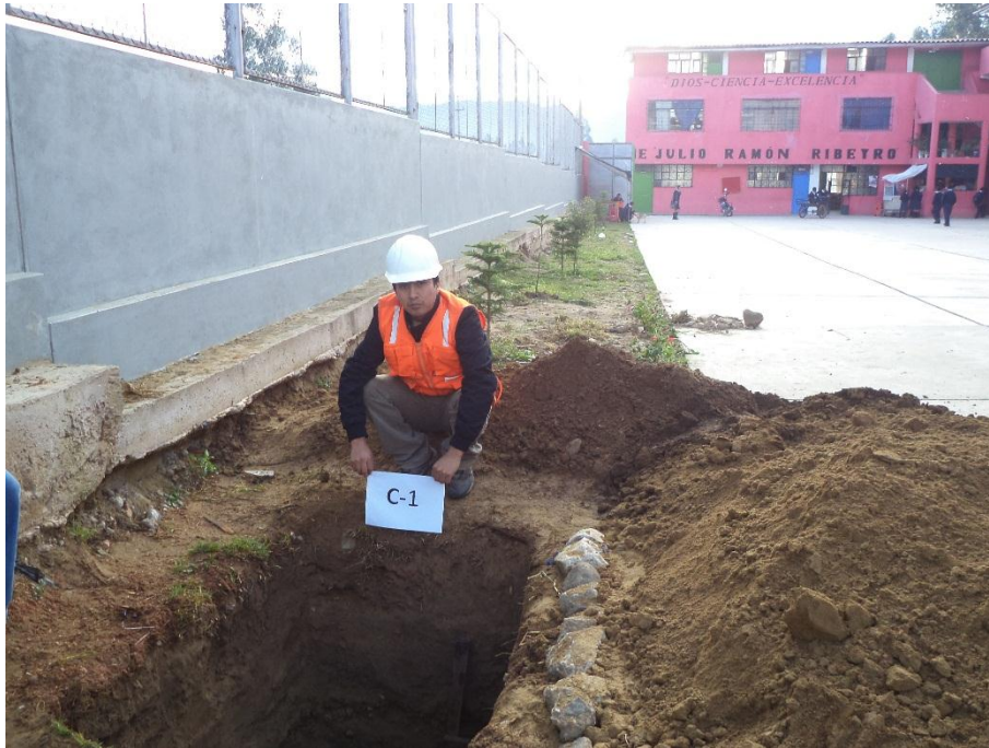
Figura N° 7.19. Calicata N°01, ubicada a un costado del módulo "B" de dos niveles.
