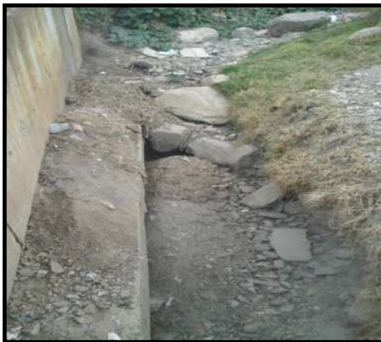
Fotografía N° 13. Arrojo de desmonte a la quebrada por parte de población aledaña.
