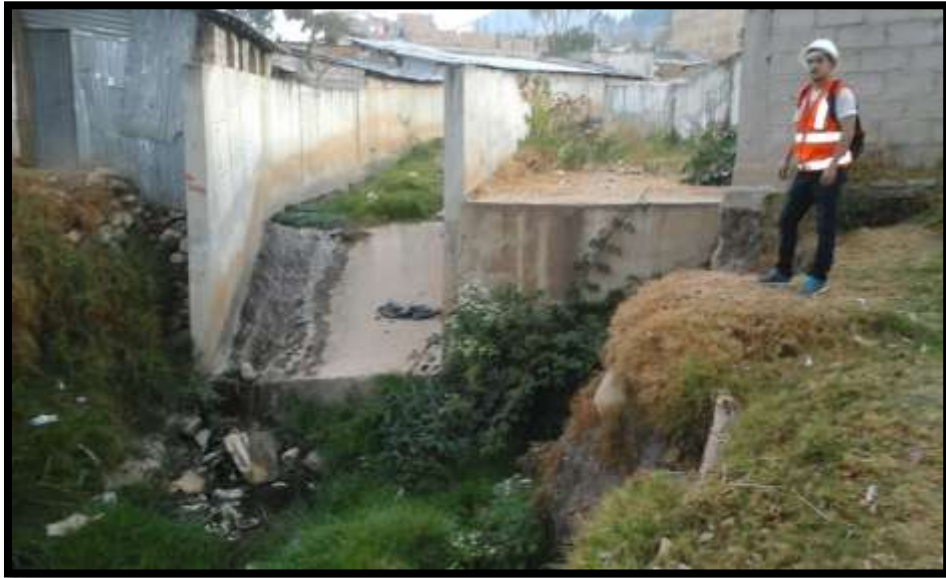
Fotografía N° 02. Albiadero fuera de funcionamiento.
