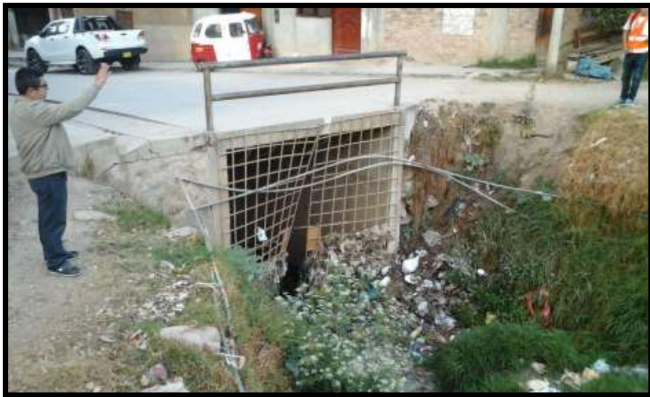
Fotografía N° 03. Reja colocada en el encausamiento por los pobladores para evitar la concentración de delincuentes, pero que ha causado la acumulación de basura, además de que se puede observar tubería expuesta.
