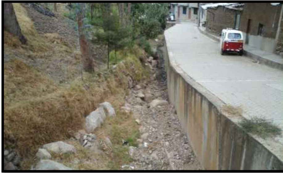
Fotografía N° 12. Reducción del ancho de la quebrada por invasión de terrenos aledaños.
