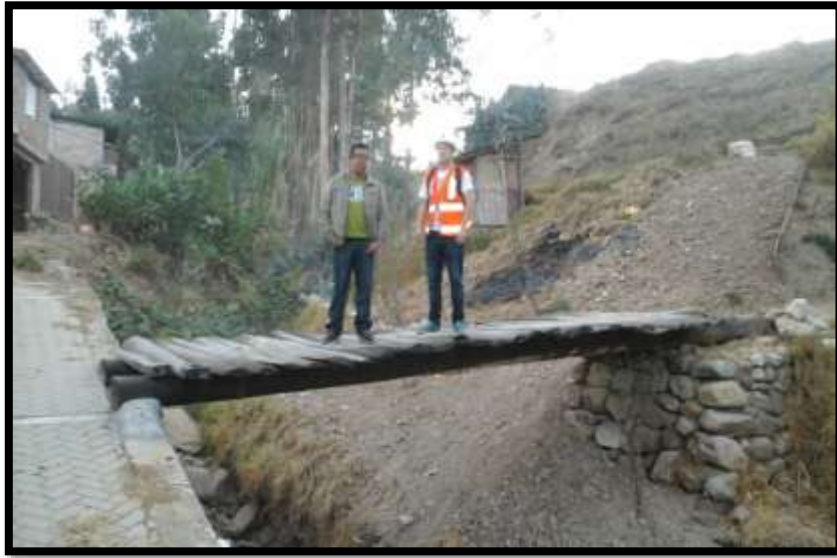
Fotografía N° 16. Puente construido por pobladores que no cumple con ninguna medida de seguridad.
