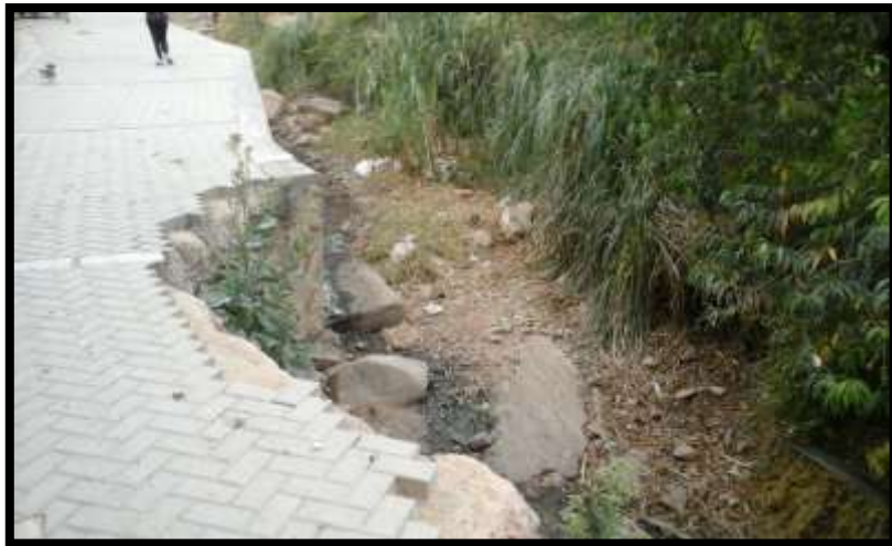
Fotografía N° 11. Mal estado de las vías aledañas a la quebrada.
