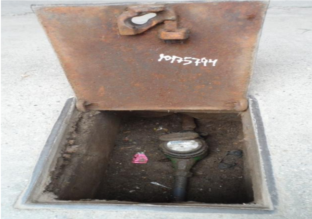
Caja del medidor ubicada en el suelo, con presencia de humedad.
