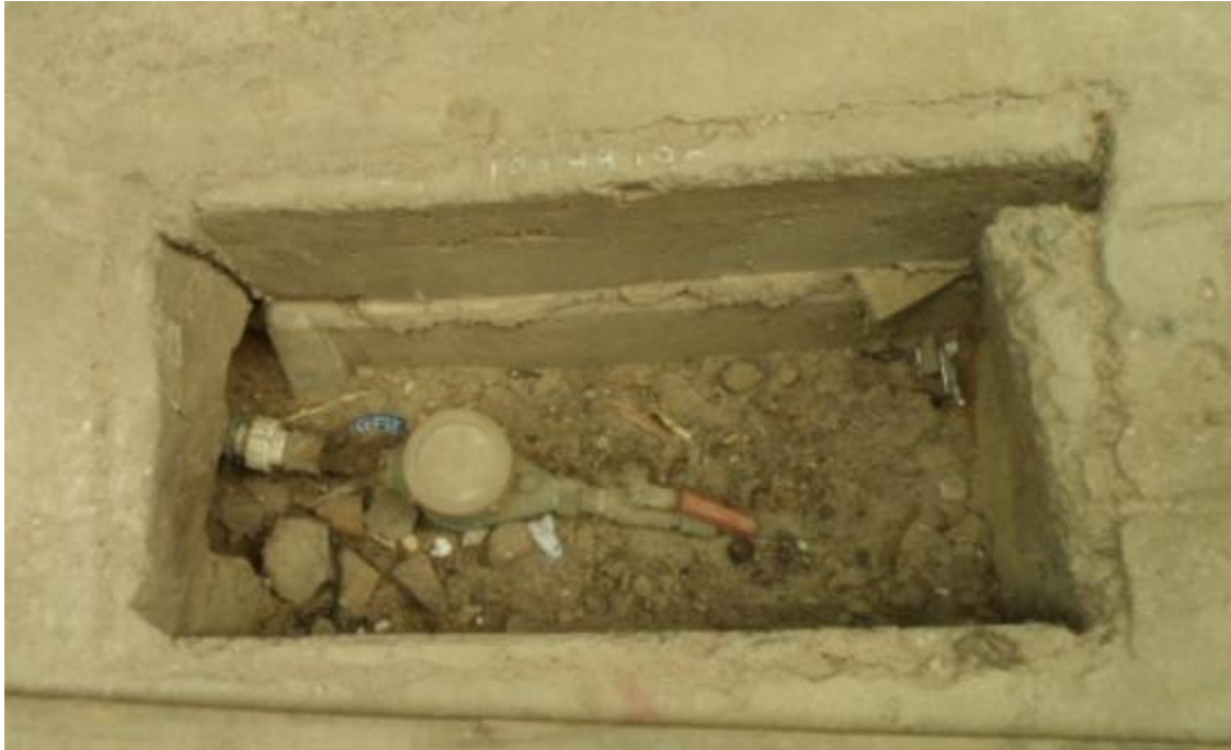
Medidor en el suelo, sin tapa y expuesto.
