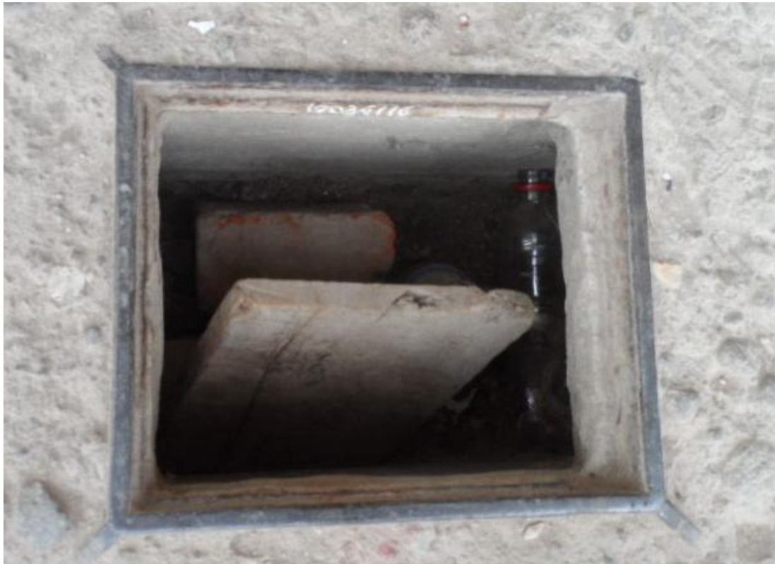
Medidor en el suelo, sin tapa, expuesto y madera sobre el medidor.
