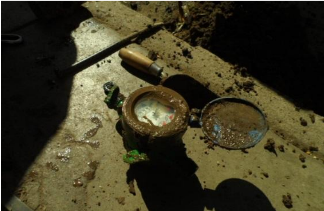
Medidor retirado, con presencia de lodo a causa de la humedad.
