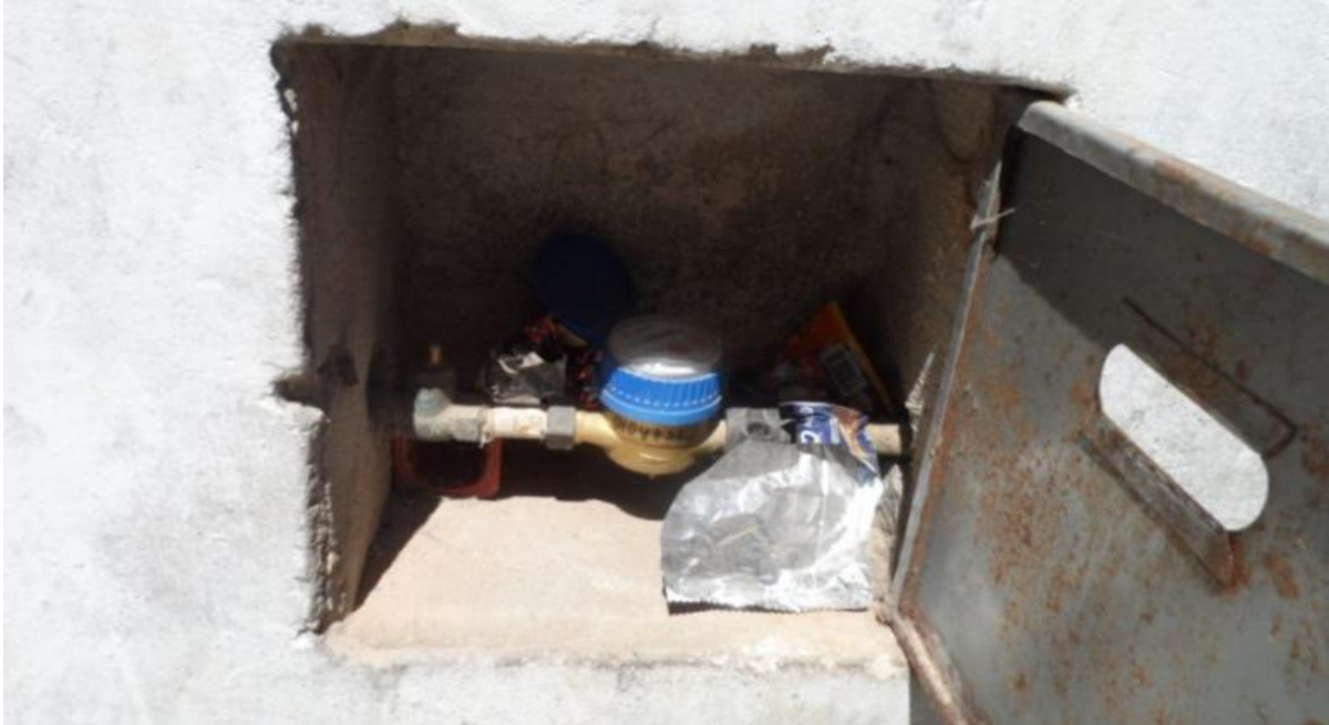
Medidor a simple inspección: Caja del medidor con basura y polvo.
