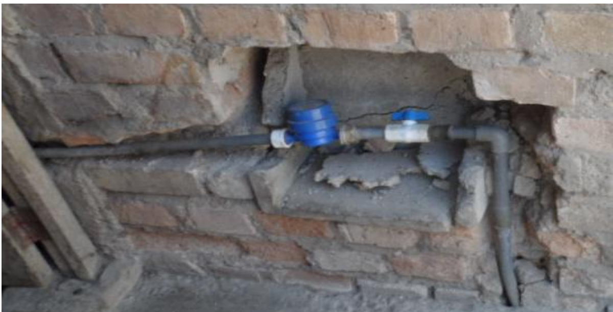
Caja del medidor rota y medidor expuesto.
