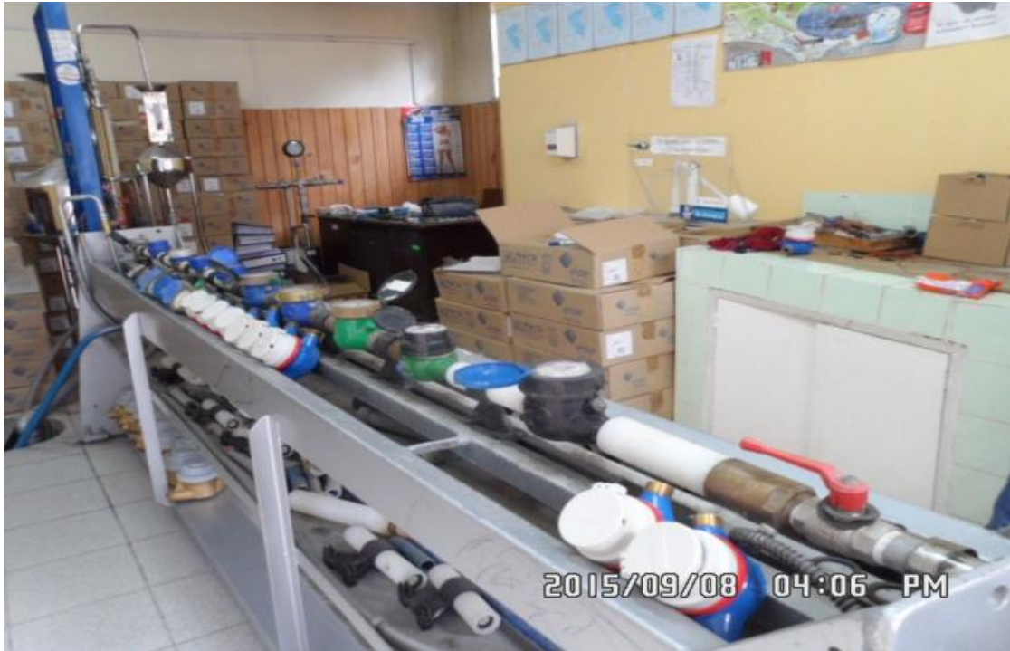
Banco de medidores, con una capacidad para diez medidores.
