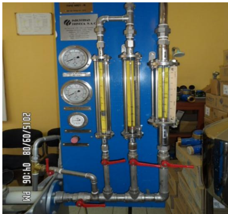
Tres rotámetros con sus llaves cada uno, servirán para las tres pruebas en los medidores
