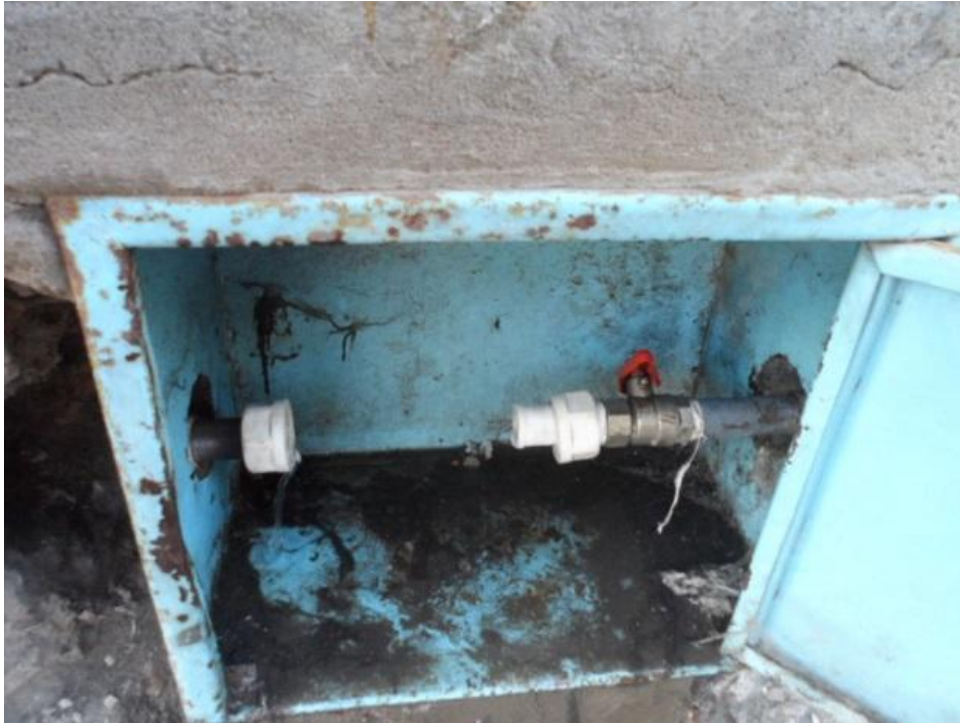
Caja de medidor en pared con presencia de óxido y polvo, se observa el retiro del medidor.
