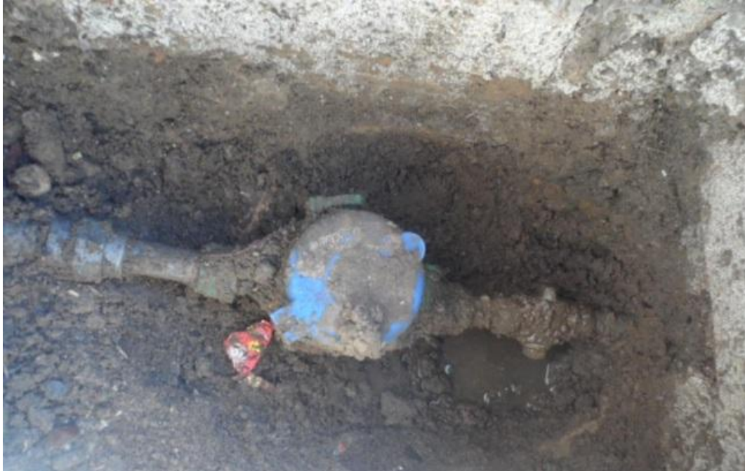
Caja de medidor en el suelo con presencia de humedad.
