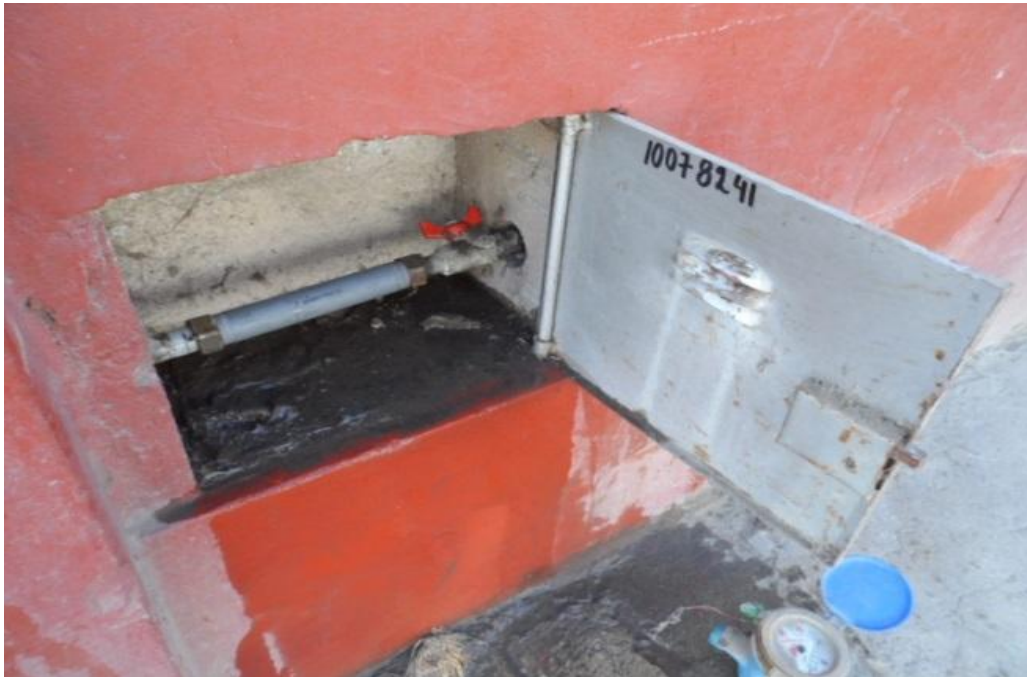
Caja de medidor en pared, al retirar el medidor se coloca niple dependiendo el diámetro de los accesorios, para evitar el corte del sistema de agua.
