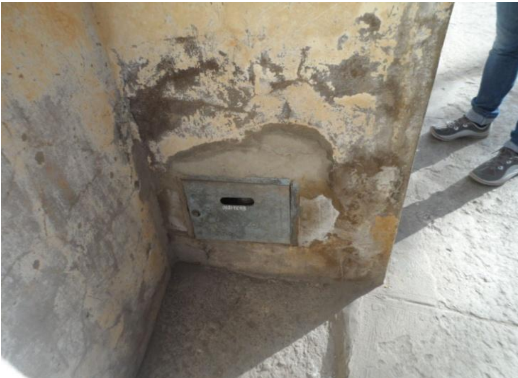
Signos visibles de la presencia de humedad afectando a la pared.
