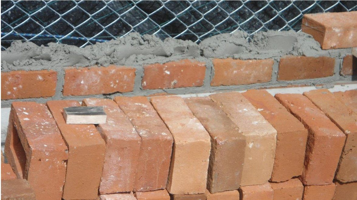
FOTO N° 22: Espesor De Junta De Mortero
