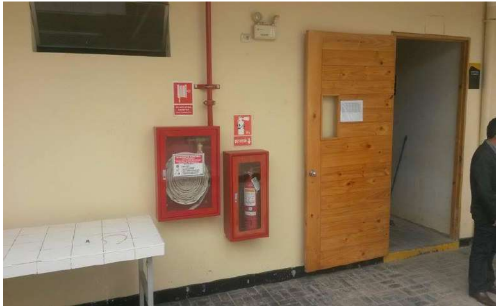
Fotografía 1: Ubicación de sistema contra incendios
