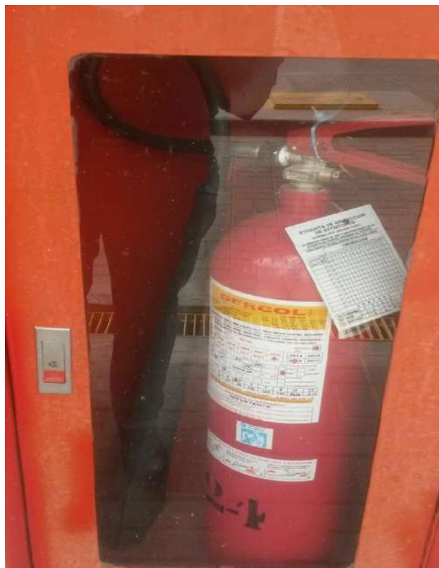
Fotografía 2: Disposición de extintor
