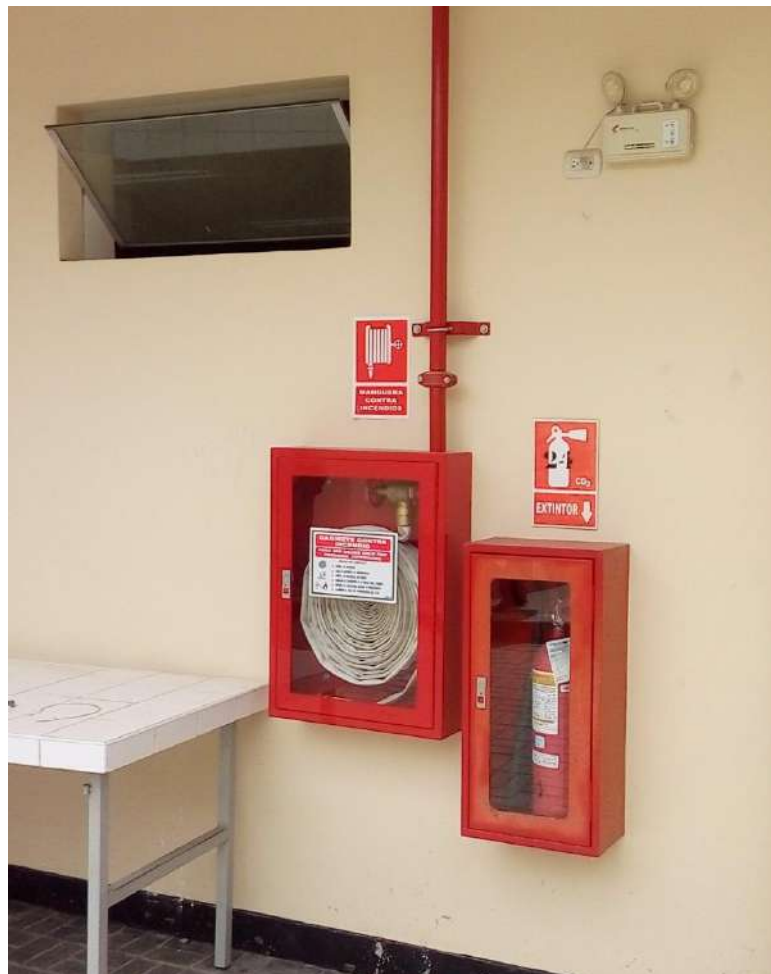
Fotografía 4: Ubicación de gabinete contra incendios
