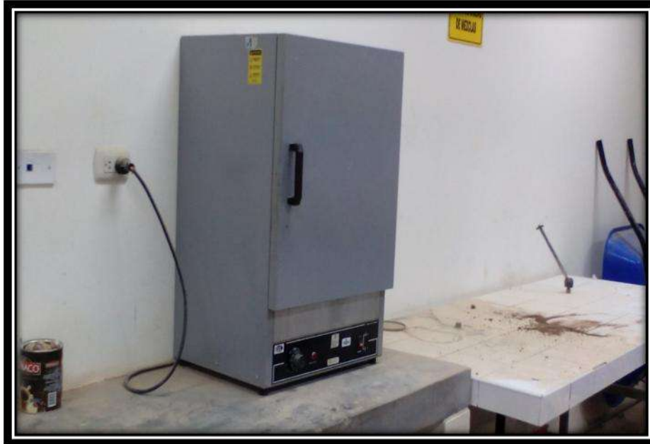
Fotografía N° 5: Verificación de Instalaciones eléctricas (Laboratorio de concreto, Horno eléctrico para secado de muestras)
