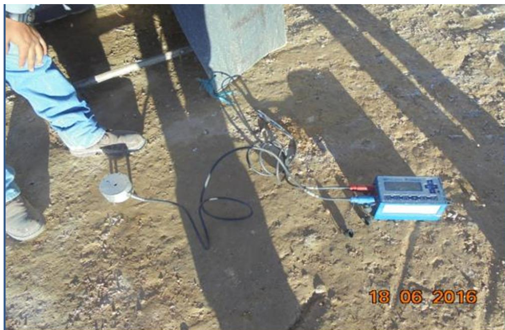
Figura 5.5 Detalle de instalación del equipo de medición.
