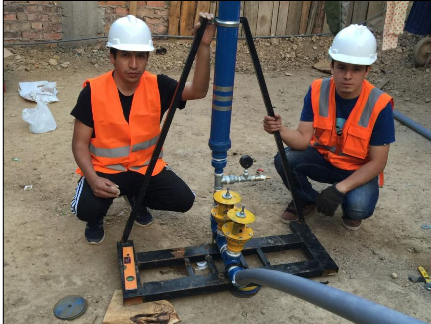
Fotografía N° 19: Segundo ensayo realizado en campo; en el que se plantea una alimentación directa al sistema hidráulico.
