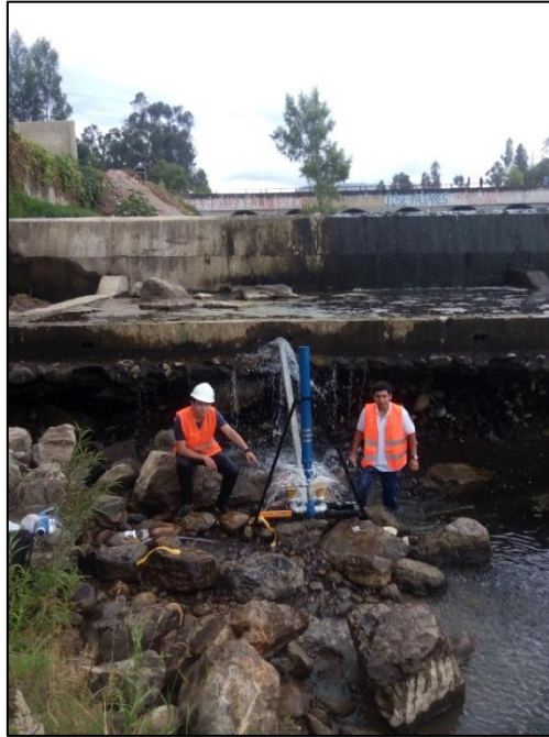
Fotografía N° 41: Quinto ensayo realizado en campo en el Viaducto de Los Baños del Inca, en el que se observa la puesta en marcha de la bomba de ariete hidráulico.
