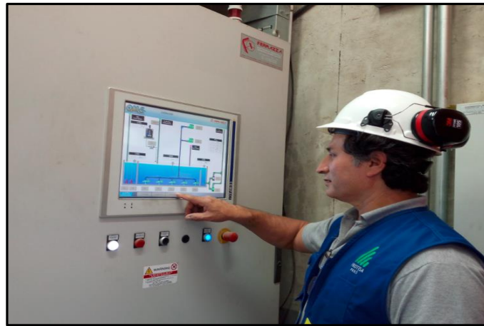
Figura n.º 3-10. Pantalla de Operación de dosificación de los Químicos.
