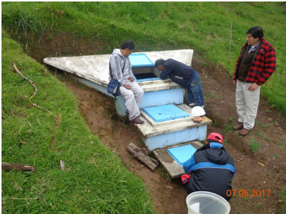
Figura nº. 35: Captación 1 – Maraynillo.
