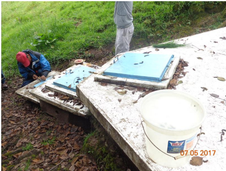
Figura nº. 41: Captación 3 – Maraynillo.
