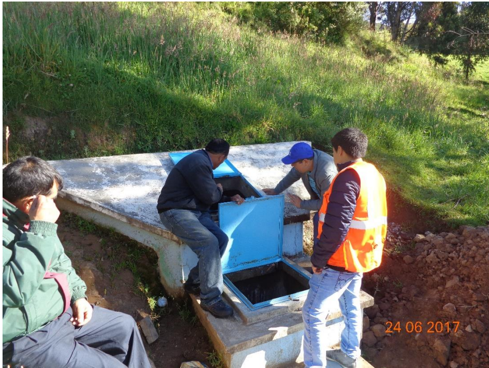
Figura nº. 66: Inspección de captaciones y filtros por parte del Dr. Ingeniero Orlando Aguilar
