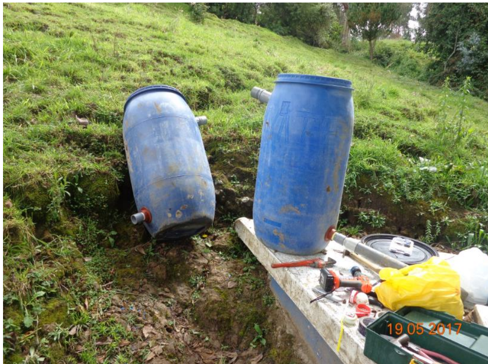
Figura nº. 57: Accesorios instalados en los tanques.
