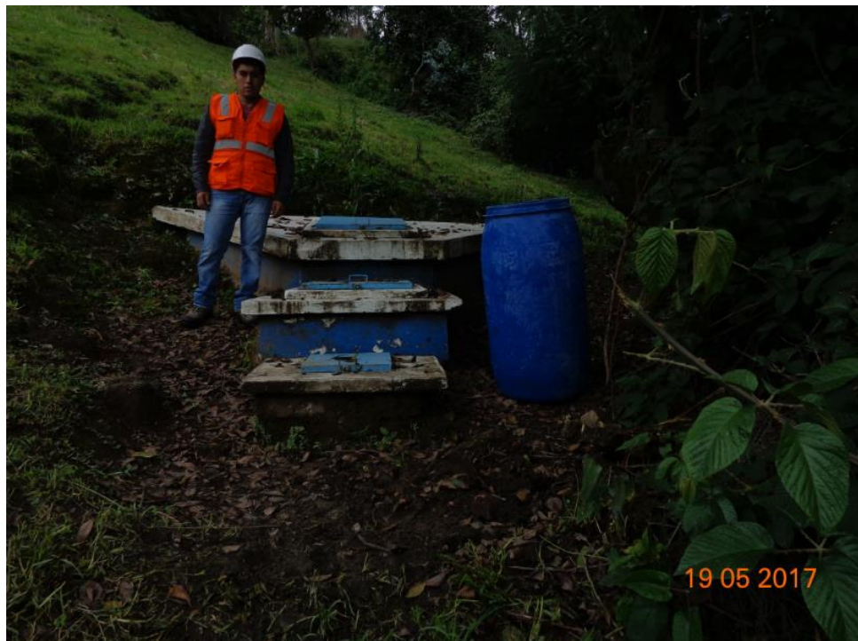
Figura nº. 50: Tanque ubicado en captación 3.
