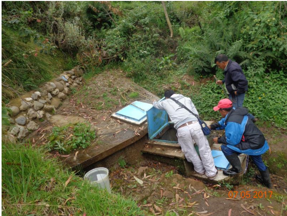
Figura nº. 38: Captación 2 – Maraynillo.
