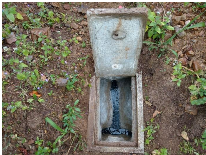
Fotografía 8. Vista del interior de caja distribuidora de flujos
