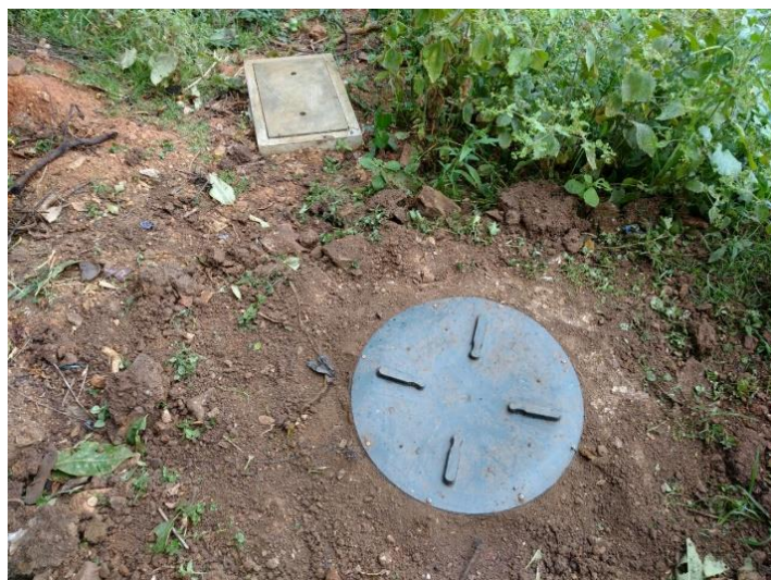
Fotografía 9. Vista de biodigestor y caja de distribución de flujos
